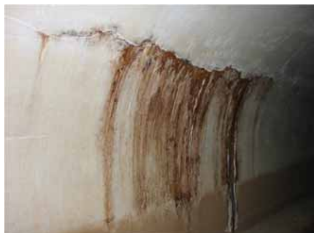
写真-2.2.9 偏土圧による水平ひび割れ
