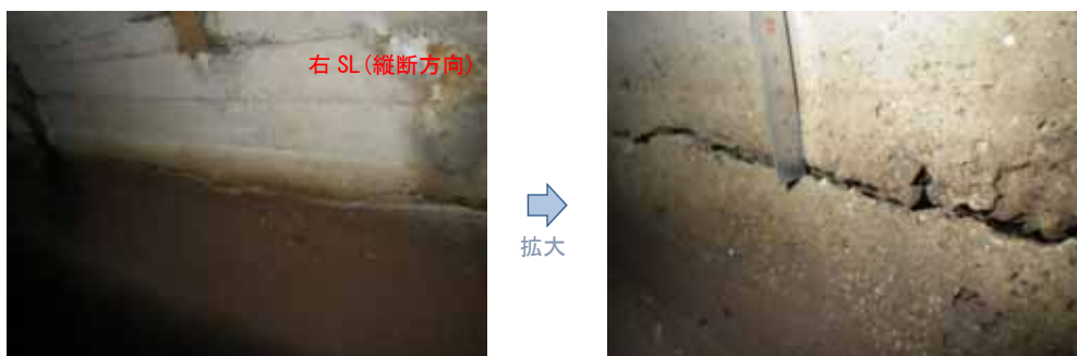
写真-2.3.1 スプリングラインのひび割れ
