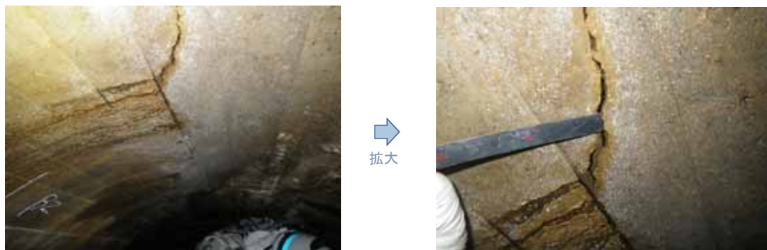
写真-2.2.7 緩み土圧によるひび割れ
