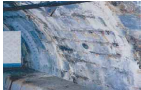
写真-2.2.11 塩害（鉄筋に沿ったひび割れ）
