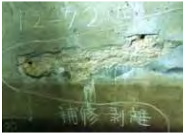
コンクリートの剥落・欠損
