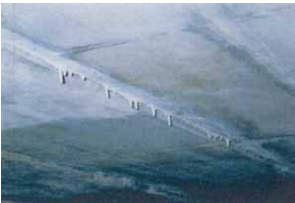
写真-2.2.16 漏水箇所の水酸化カルシウム
