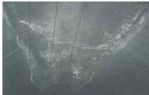
写真-2.2.6 水路トンネル覆工のコールドジョイントによるひび割れ発生状況
