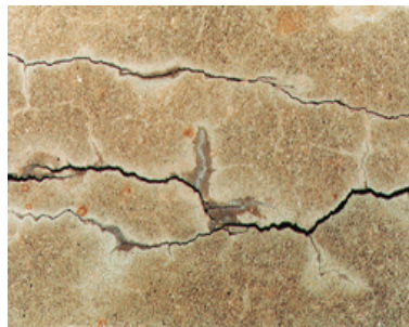
ゲルがえぐられひび割れ発生 (中期)
