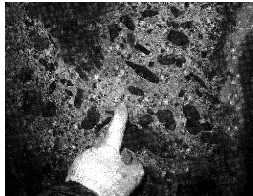
写真-2.2.14 剥落により粗骨材露出（凍害）
