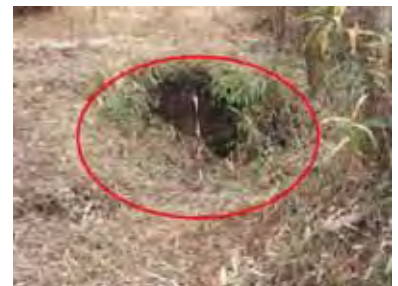
地盤の崩落・陥没
