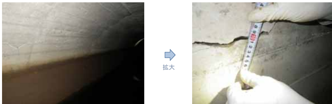
写真-2.2.8 塑性土圧によるひび割れ
