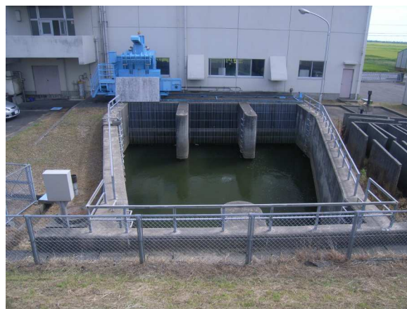
写真-9.2.6 除塵設備上流部
