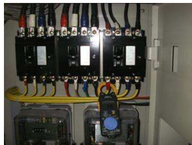
クランプメータによる電流測定
