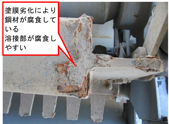
写真-9.1.5 レーキの腐食の例
