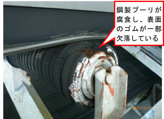
写真-9.1.9 キャリアローラの劣化割れの例
