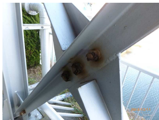
写真-9.1.13 接合部（ボルト）の腐食の例
