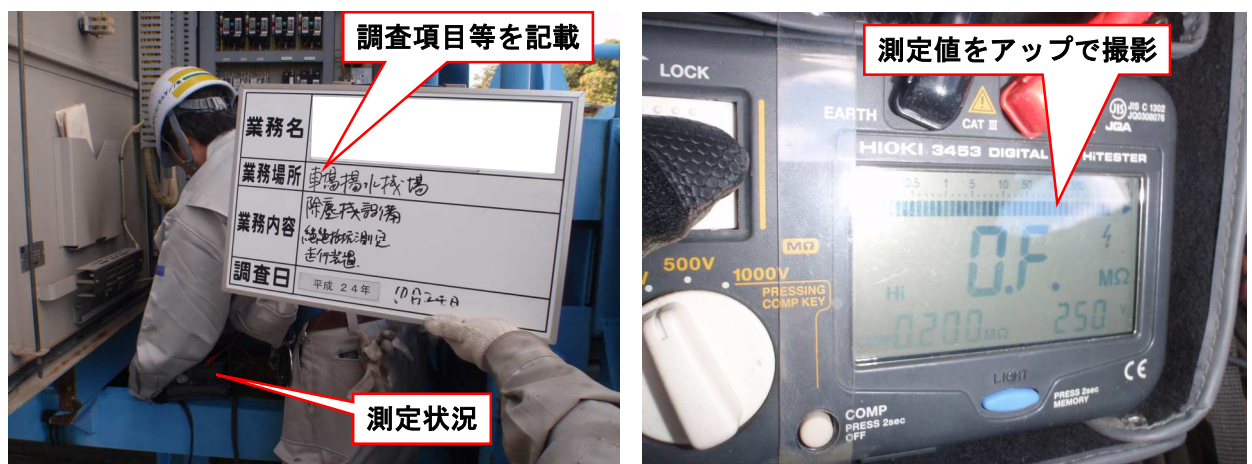
写真-9.2.10 絶縁抵抗測定例
