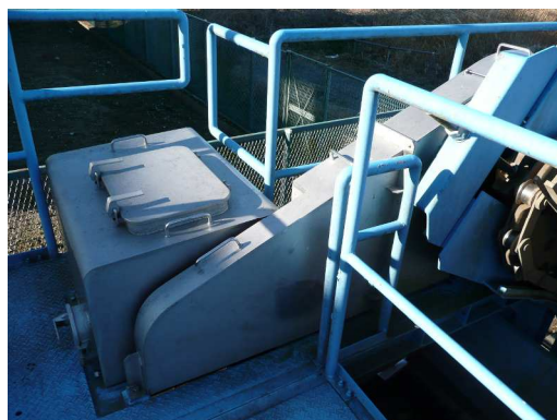
写真-9.2.8 除塵機駆動部
