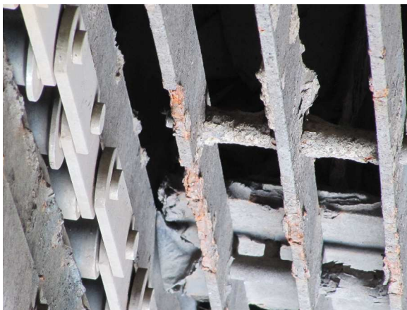
写真-9.2.4 スクリーン腐食
