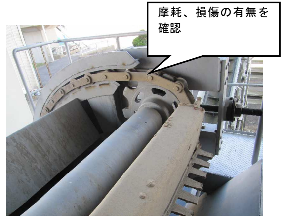
写真-9.2.3 レーキチェーンの摩耗、損傷
