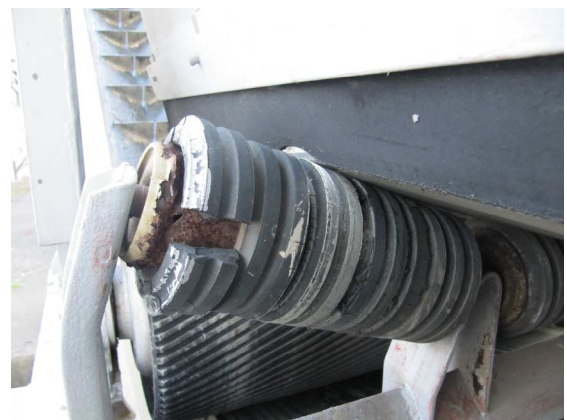
写真-9.2.5 明らかな異常（キャリアローの劣化）
