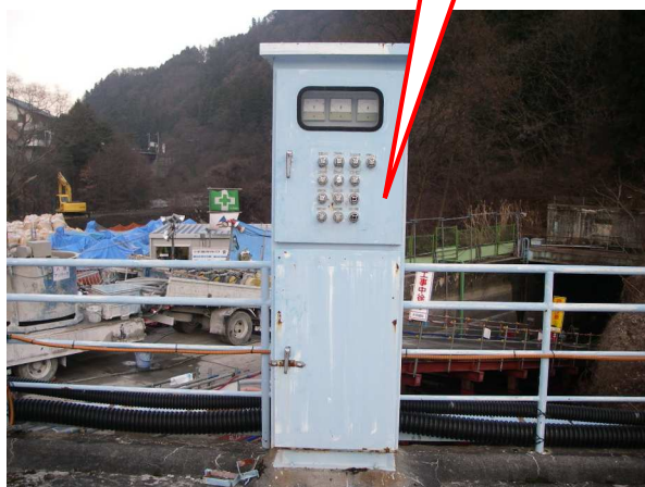
写真-9.1.14 機側操作盤の外表面劣化の例
