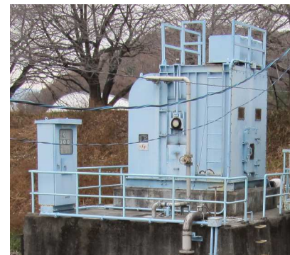
ネット形除塵機全景例
