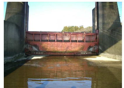
対象ゲートのみを全閉にした状態
