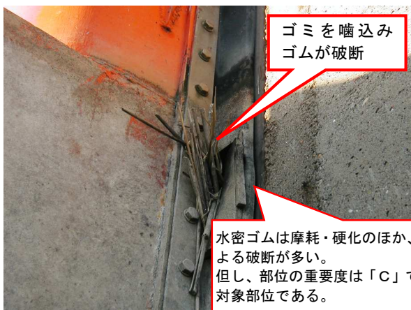
写真-6.1.13 水密ゴムの破損の例
