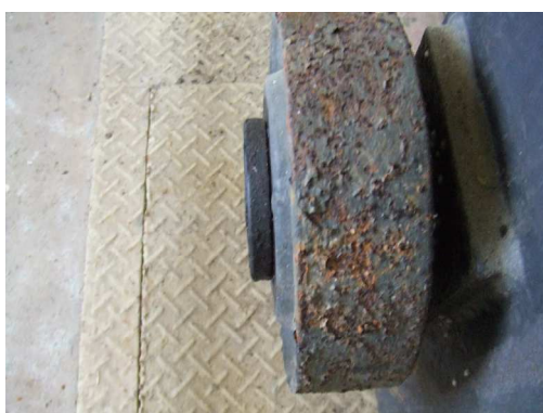
写真-6. 2. 11 主ローラの劣化事例
