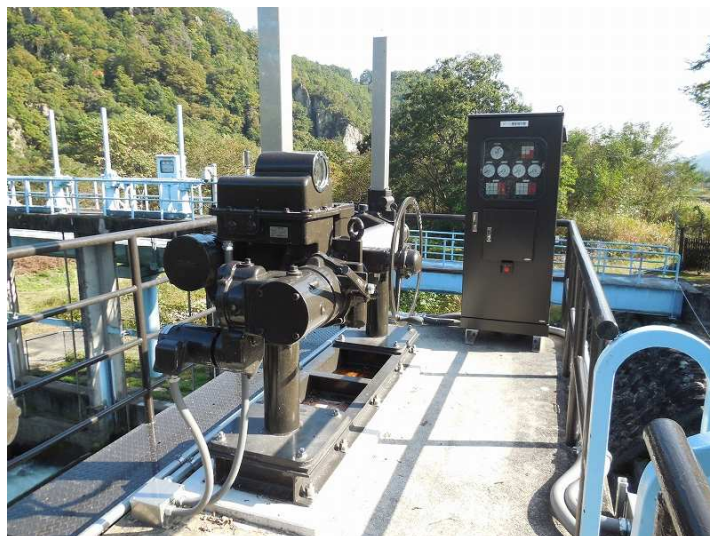
写真-6.1.6 ラック式開閉装置の事例写真
