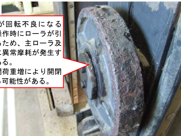
写真-6.1.11 主ローラ踏面の腐食の例
