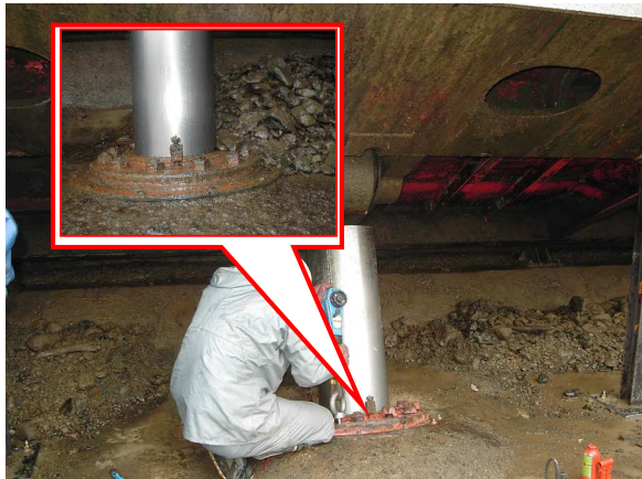
写真-6. 1. 29 油圧シリンダの腐食の例
