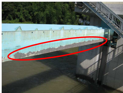
写真-6.2.4 扉体下部の塗装剥離状況
