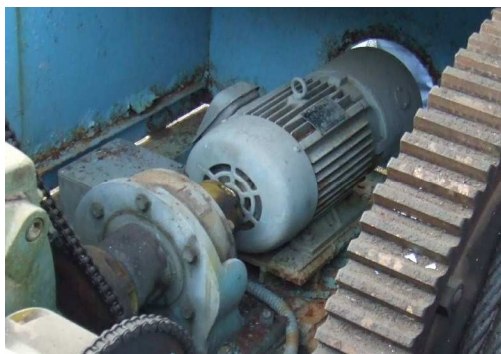
写真-6. 2. 10 電動機の性能低下事例
