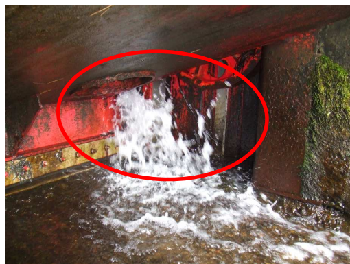
写真-6.2.5 扉体底部からの漏水状況
