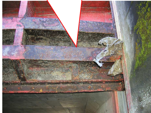
写真-6.1.10 主桁の腐食の例
