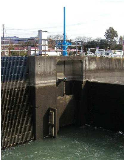
写真-6.1.4 沈砂池の排砂ゲートの設置例
