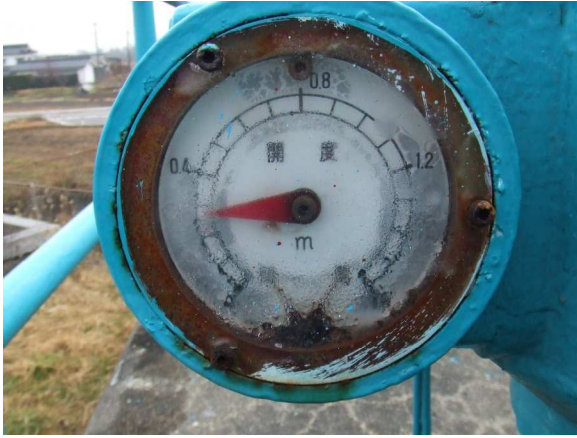
写真-6. 1. 28 腐食による開度計の作動不良の例
