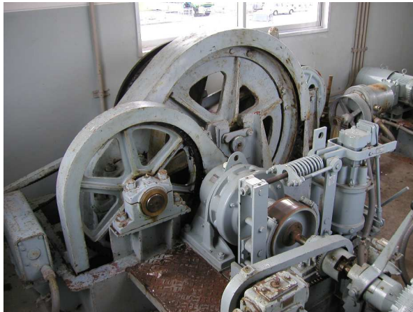
写真-6.1.16 開閉装置全体の腐食の例
