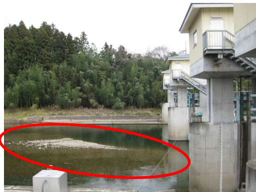
写真-6.2.2 ゲート上流部の堆砂状況
