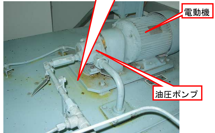
写真-6. 1. 30 油圧ユニットの油漏れの例
