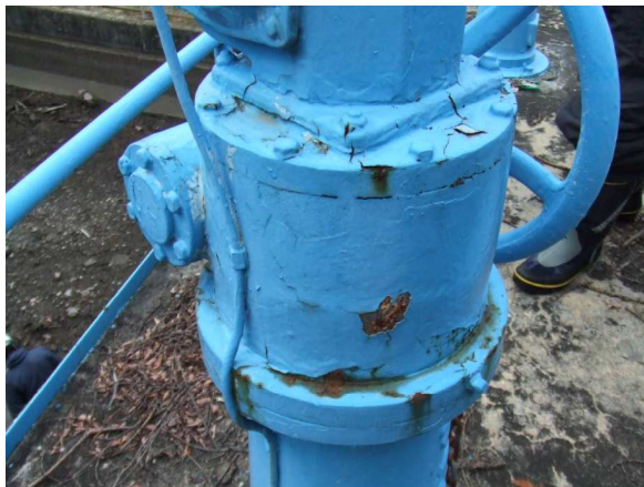
写真-6.1.25 スピンドル式開閉機の全体腐食の例
