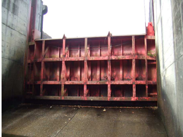
写真-6.1.9 扉体の塗膜損傷及び腐食の例
