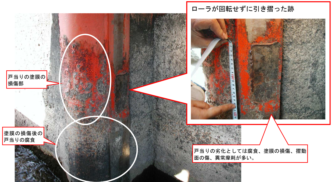
写真-6.1.15 戸当りの腐食、塗膜の損傷、傷（ローラゲート）
