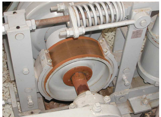
写真-6.1.17 制動機のドラムの腐食の例
