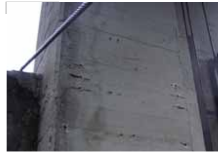
写真-4.2.14 塩害（水門門柱） （鉄筋に沿ったひび割れ）
