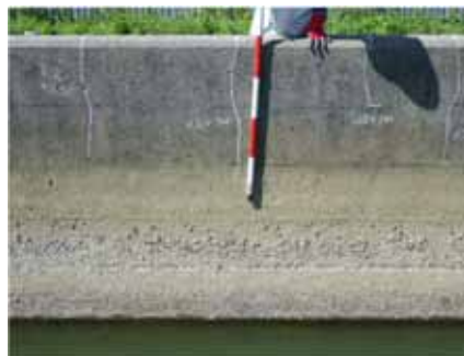
写真-4. 2. 10 乾燥収縮ひび割れ
