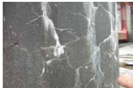
写真-4.3.1 アルカリ骨材反応が要因のひび割れ
