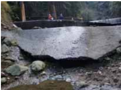
エプロン下の空洞化
