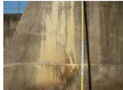
ひび割れ(初期ひび割れ)
