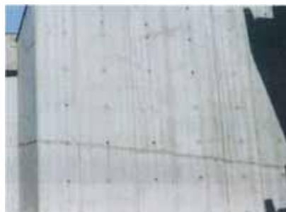
写真-4. 2. 11 コールドジョイントによるひび割れ
