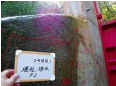
ひび割れ(外力)
