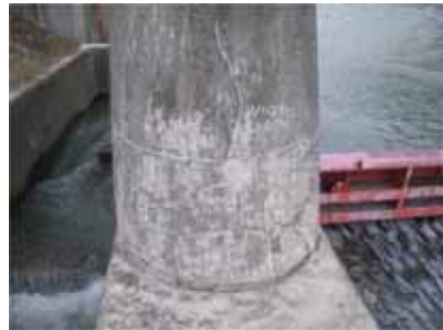
ひび割れ(凍害)
