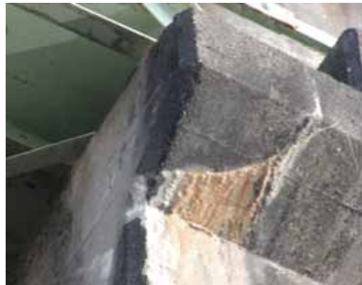
写真-4.2.18 エフロレッセンス+錆汁 （管理橋）
