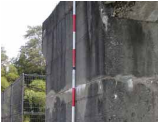
写真-4.2.17 エフロレッセンス（堰柱）
