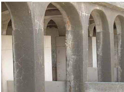
写真-4.2.13 塩害（RC 管理橋） （塩害と ASR の複合劣化）
