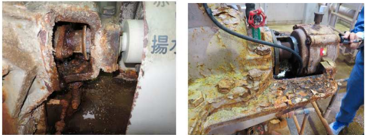
ポンプ封水部の塗装劣化及び錆の状態の例
