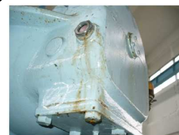
軸受け部から少し漏油有
