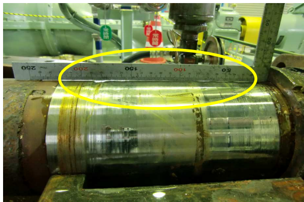
(c) パッキンスリーブの摩耗状況 (スリーブが大きく摩耗している。定規との間に隙間が生じている)
