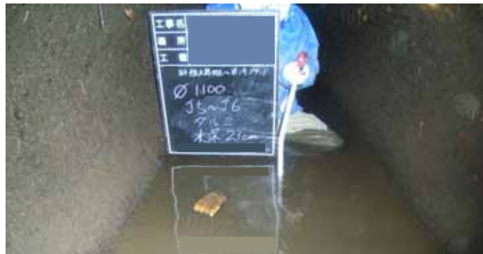
写真-3.2.26 残留水の水位測定
