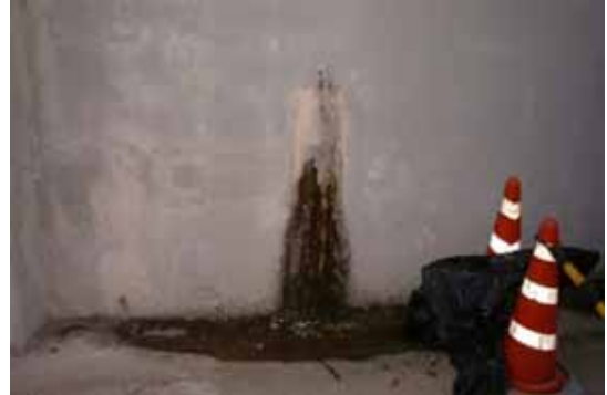
写真-3. 2. 65 PCタンクの温度ひび割れの事例
