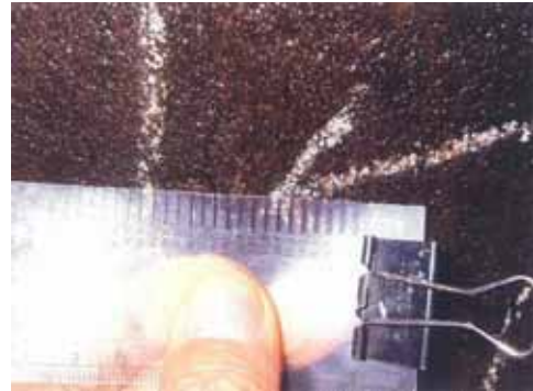
写真-3.2.19 クラックスケールによる測定
