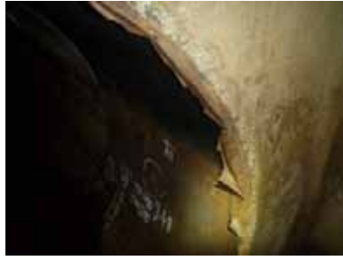
内面塗装劣化 (SP)
