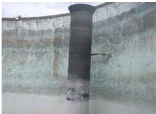
写真-3.2.78 内面塗装の劣化
