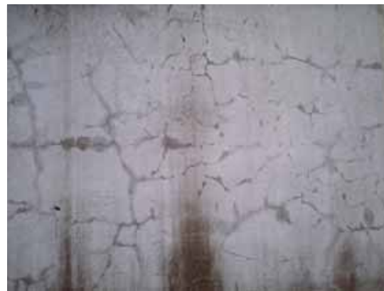
写真-3.2.69 モルタル層のひび割れ
