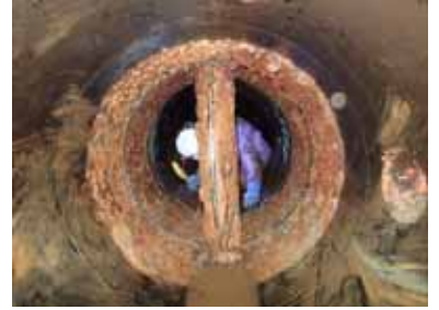
腐食 (DCIP 弁部)
