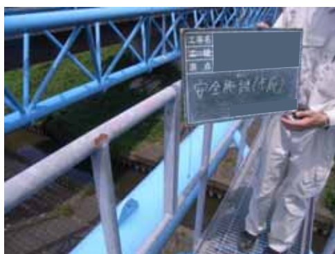
写真-3. 2. 41 歩廊の劣化（錆）
