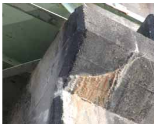
写真-3.2.56 エフロレッセンス+錆汁
