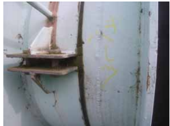
写真-3. 2. 46 ゴムの劣化
