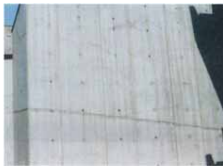
写真-3. 2. 49 コールドジョイントによるひび割れ
