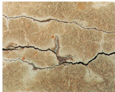
ゲルがえぐられひび割れが発生 (中期)
