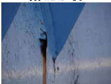
写真-3.2.34 ふくれとさび
