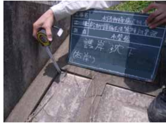
写真-3. 2. 63 周辺地盤の沈下例
