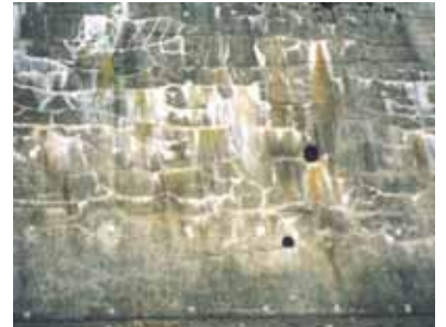
鉄筋の腐食により錆汁が発生 (後期)
