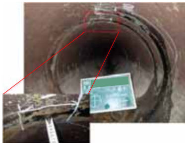
管頂のひび割れ (FRPM)
