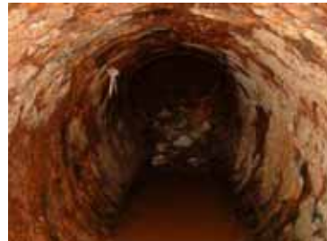
写真-3.2.24 一定範囲で全体的に錆が確認
