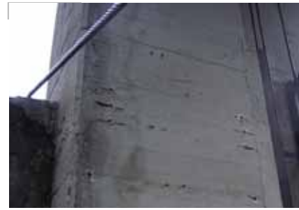
写真-3.2.52 塩害 (鉄筋に沿ったひび割れ)
