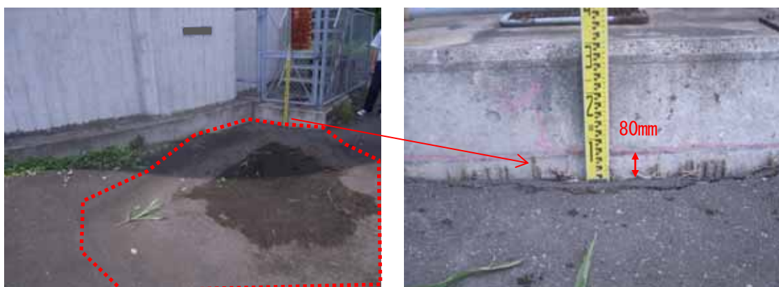
写真-3.2.80 地盤沈下による抜け上がりの例
