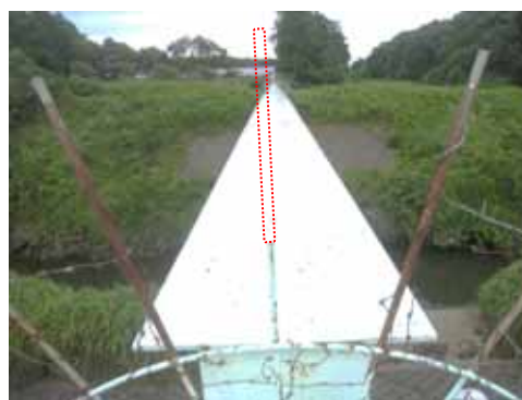
写真-3. 2. 42 侵入防止柵の損傷
