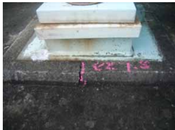
写真-3.2.44 台座のひび割れ
