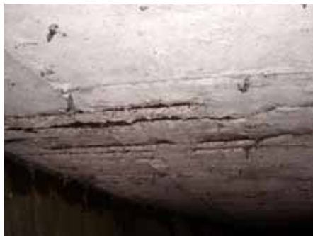
写真-3.2.66 中性化（ボックスカルバート）；鉄筋に沿ったひび割れ；塩害も同様の形状を示す
