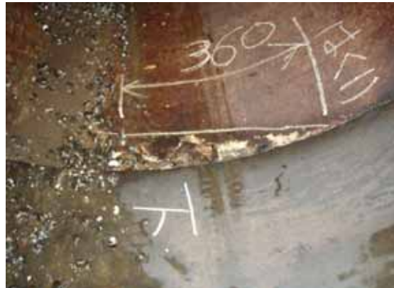
写真-3. 2. 22 腐食状況の記録
