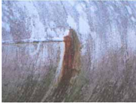
写真-3. 2. 40 漏水痕跡
