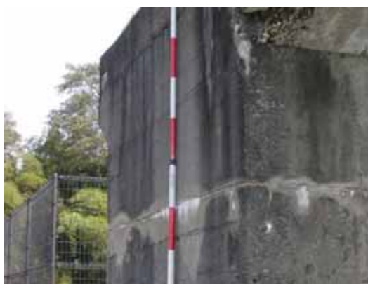
写真-3.2.55 エフロレッセンス
