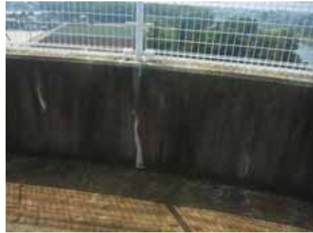
写真-3.2.71 エフロレッセンス
