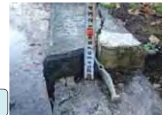
目地部の段差
