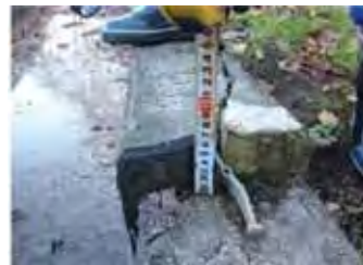
写真 止水板部から生じたひび割れ
