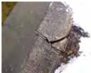
写真 止水板の破断
