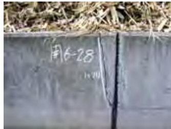
写真 周縁コンクリートの欠損
