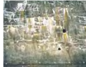
錆汁とゲル（析出物）
