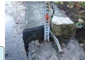
目地部の段差
