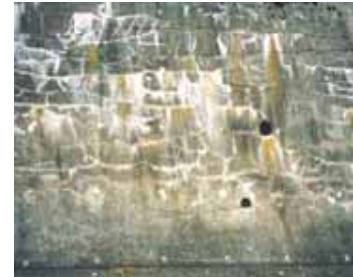
錆汁とゲル（析出物）
