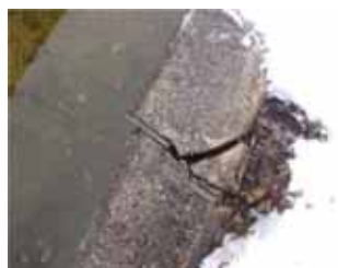
写真 止水板の破断
