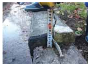
写真 止水板部から生じたひび割れ
