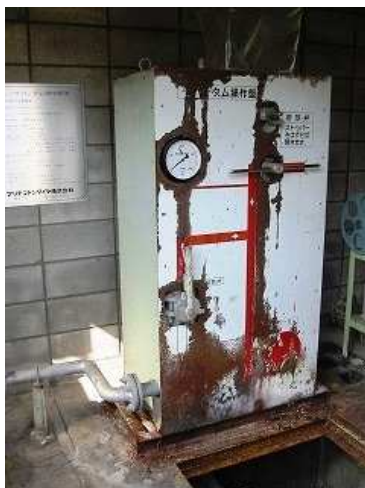
写真-7.1.14 操作装置全体の腐食の例
