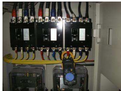
クランプメータによる電流測定
