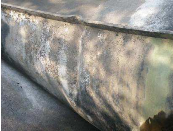
写真-7.1.6 袋体外面の全体的な劣化の例
