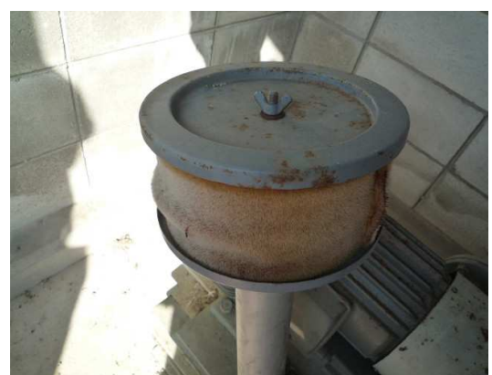
写真-7.1.17 ストレーナの目詰まりの例
