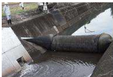
袋体下流側（起伏時）
