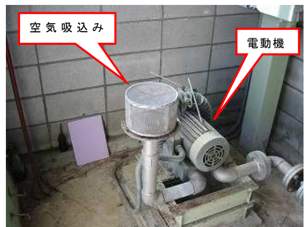
写真-7.1.15 電動機の発熱の例
