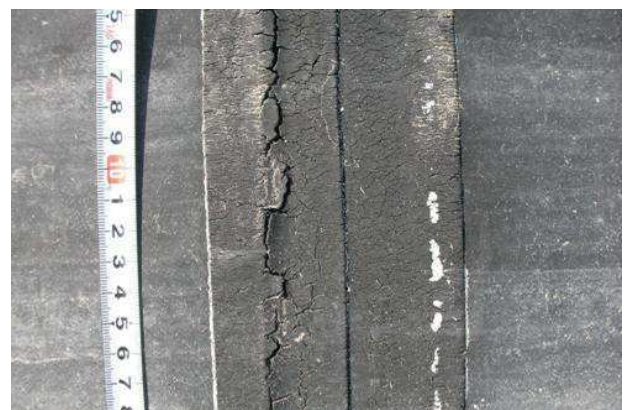
写真-7.1.11 袋体継目の劣化の例
