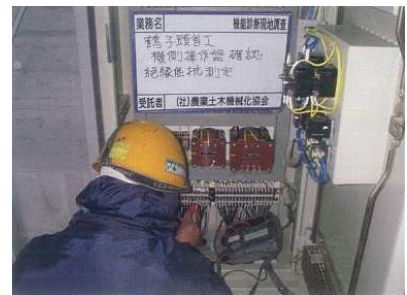
テスターによる電圧測定
