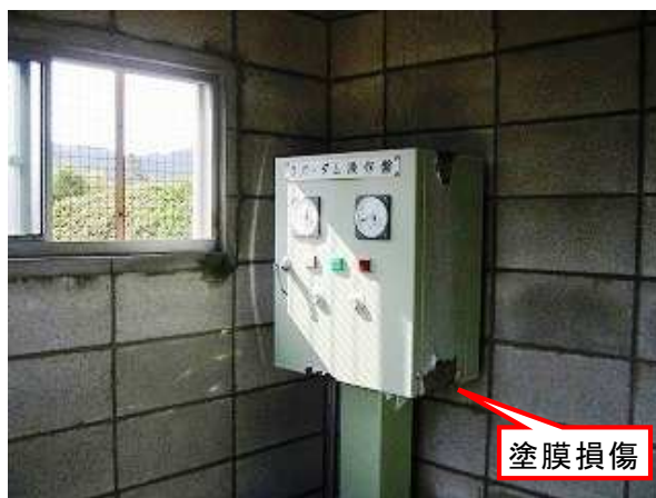
写真-7.1.19 機側操作盤の外表面劣化の例
