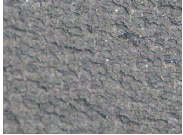
写真-7.1.7 袋体外面の劣化の例
