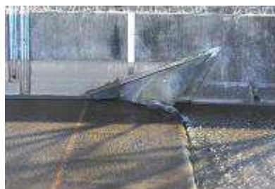
袋体上流側（倒伏時）
