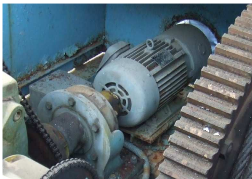
写真-6. 2. 10 電動機の性能低下事例
