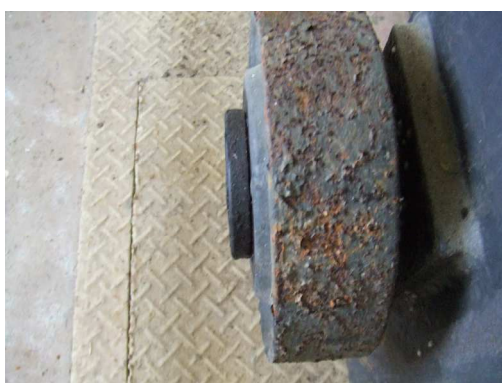
写真-6. 2. 11 主ローラの劣化事例
