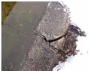
写真 止水板の破断
