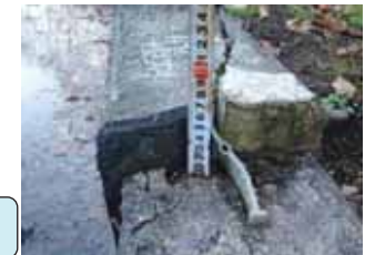
目地部の段差
