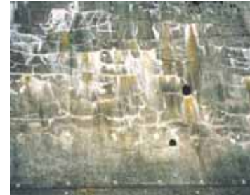
錆汁とゲル（析出物）
