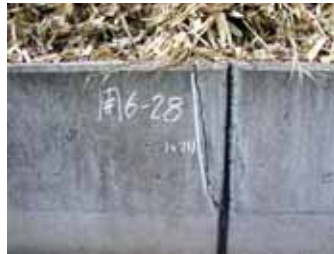
写真 周縁コンクリートの欠損
