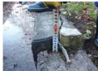
写真 止水板部から生じたひび割れ
