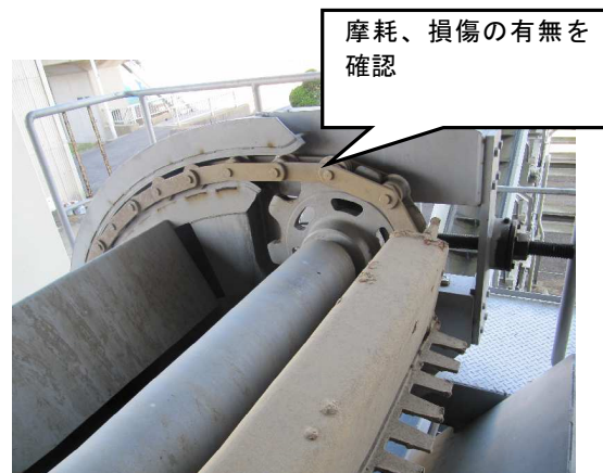
写真-9.2.3 レーキチェーンの摩耗、損傷
