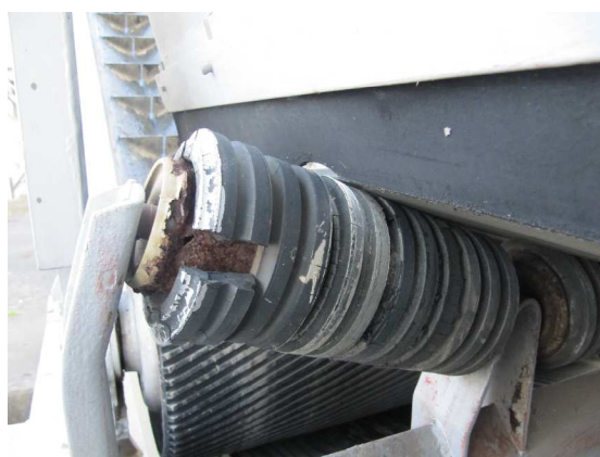
写真-9.2.5 明らかな異常（キャリアローの劣化）
