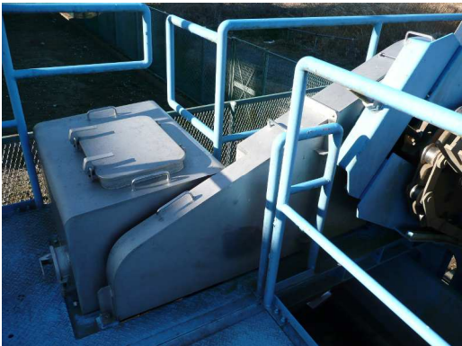
写真-9.2.8 除塵機駆動部
