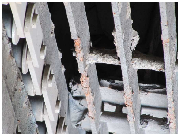
写真-9.2.4 スクリーン腐食
