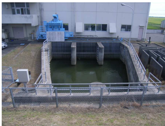
写真-9.2.6 除塵設備上流部
