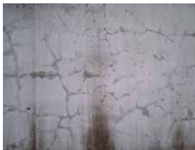
写真-1.2.13 モルタル層のひび割れ
