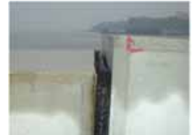
不同沈下による目地の段差
