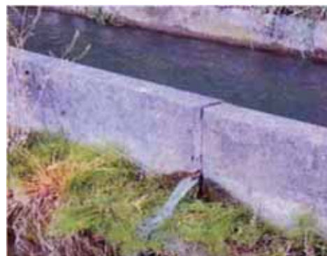
写真-1.2.26 止水板の破断に伴う漏水
