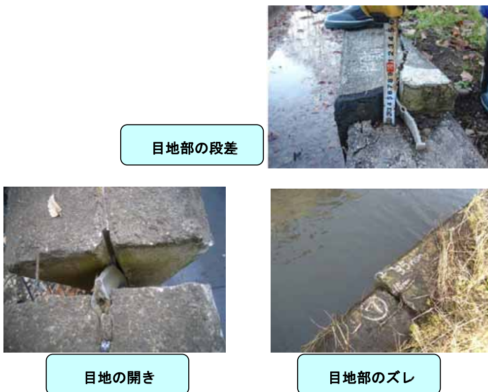
写真-1.2.21 不同沈下による目地部の変状（例）
