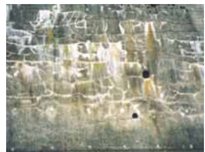
鉄筋の腐食により錆汁が発生 (後期)
