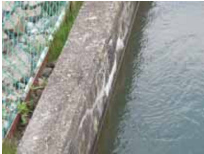
写真-1.2.11 ASRによるひび割れ
