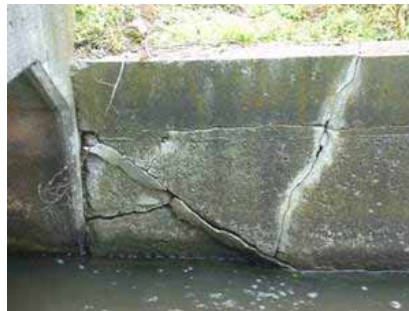
図-1.2.21 せん断ひび割れの特徴
