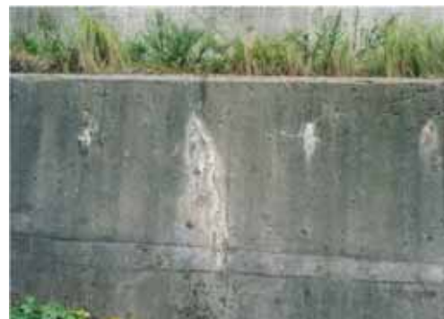
写真-1.2.14 エフロレッセンス
