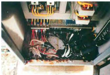
写真 5. 2. 10 盤内の腐食状態
