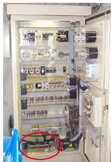
写真 5.2.11 操作盤内のスペースヒータ（例）
