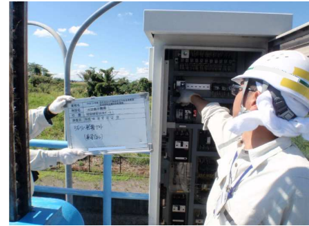
3E リレー（機側操作盤）動作確認
