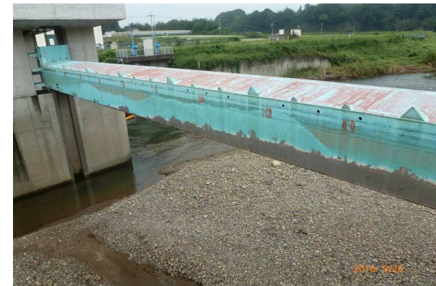
例：底部戸当りの堆砂状況
