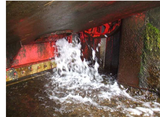
扉体底部からの漏水
