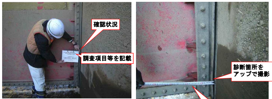
例：側部水密ゴム確認
