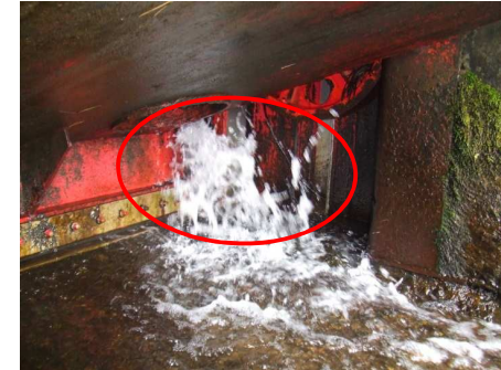
例：扉体底部からの漏水状況
