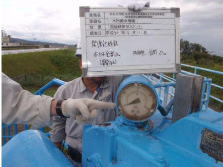
開度計（開閉装置）の動作確認
