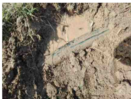
【写真 4-13 PE 管 (管体破損)】
