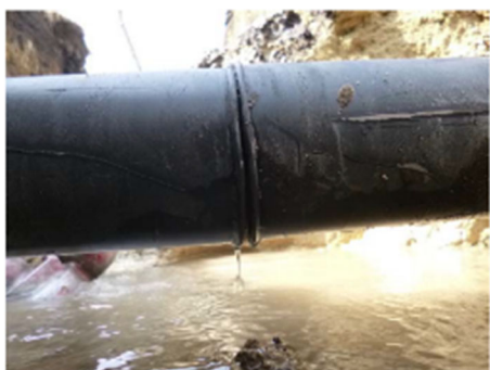
【写真 4-12 PE 管 (継手部破損)】
