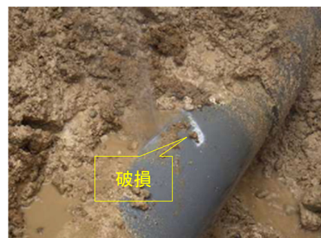
【写真 4-11 PVC 管（管体破損）】
