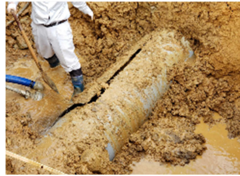
【写真 4-9 FRPM 管（管体破損）】
