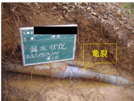
【写真 4-10 PVC 管（継手部破損）】
