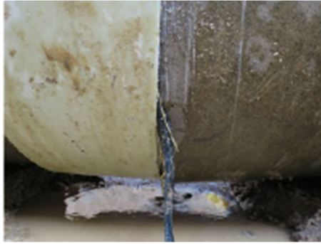
【写真 4-8 FRPM 管（ゴム輪破損）】
