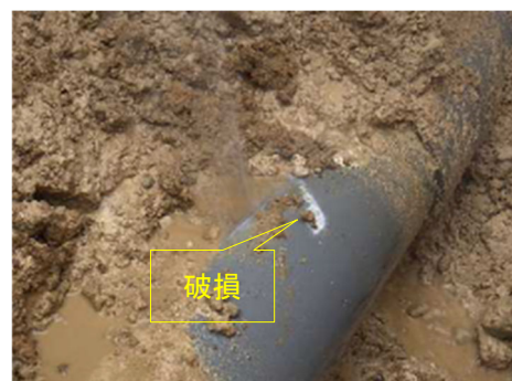
【写真 4-11 PVC 管（管体破損）】
