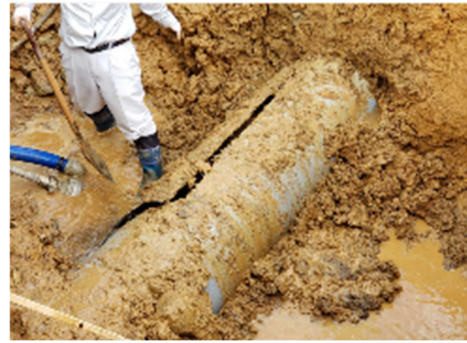
【写真 4-9 FRPM 管（管体破損）】
