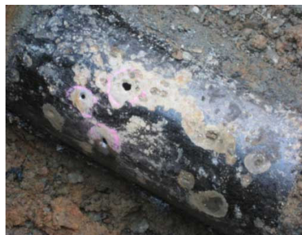
【写真4-7 SP (C/S マクロセル腐食)】
