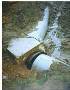
【写真3-1 曲管周辺での継手の離脱】
