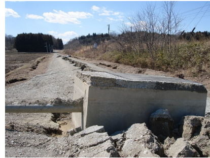
【写真3-2 液状化に伴う構造物の浮上】
