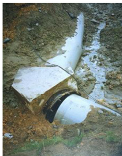
【写真1 曲管周辺での継手の離脱】
