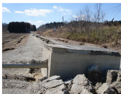
【写真2 液状化に伴う構造物の浮上】
