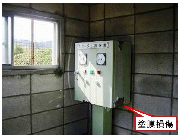
写真-7.1.19 機側操作盤の外表面劣化の例
