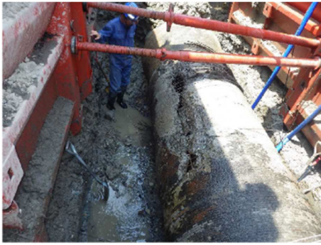
写真 3 管体損傷 (PC 管)
