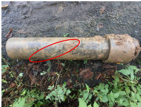
写真 5 管体損傷 (ACP)
