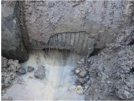
写真 1 管体損傷 (RC 管)
