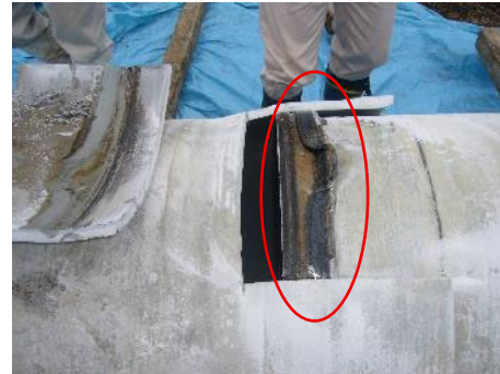
写真 12 継手損傷 (FRPM 管)
