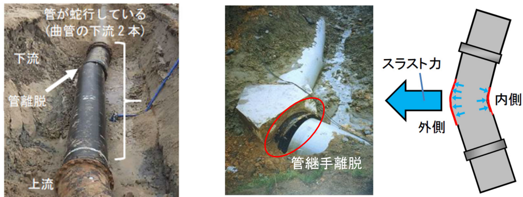
図 41 曲管部近接の被害事例
