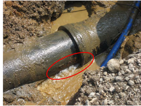
写真 10 継手損傷 (DCIP)
