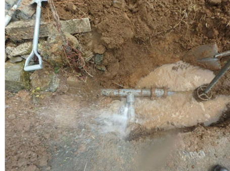
写真 14 継手損傷 (PVC 管)
