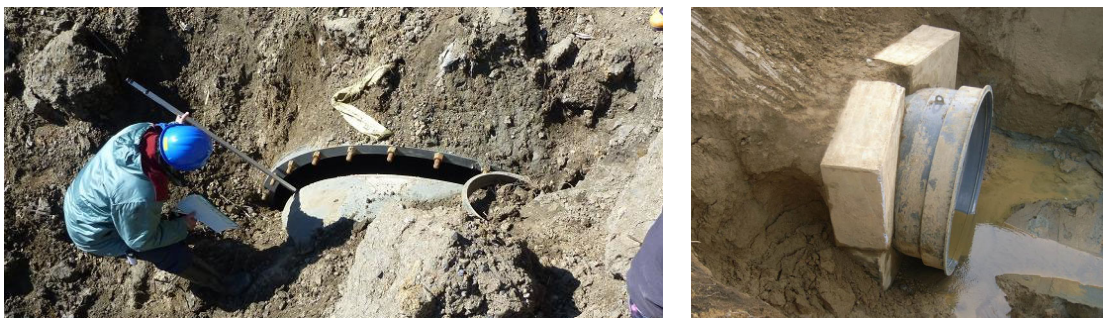
図 42 片落管の被害事例（右：片落管の変位に伴い、スラストブロックも破損）
