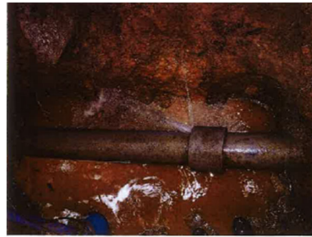
写真 6 継手損傷 (ACP)
