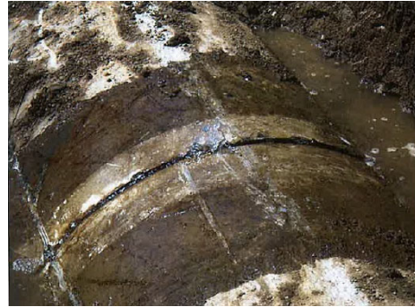
写真 2 継手損傷 (RC 管)
