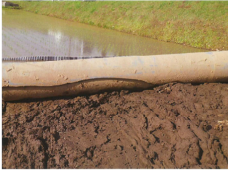
写真 13 管体損傷 (PVC 管)
