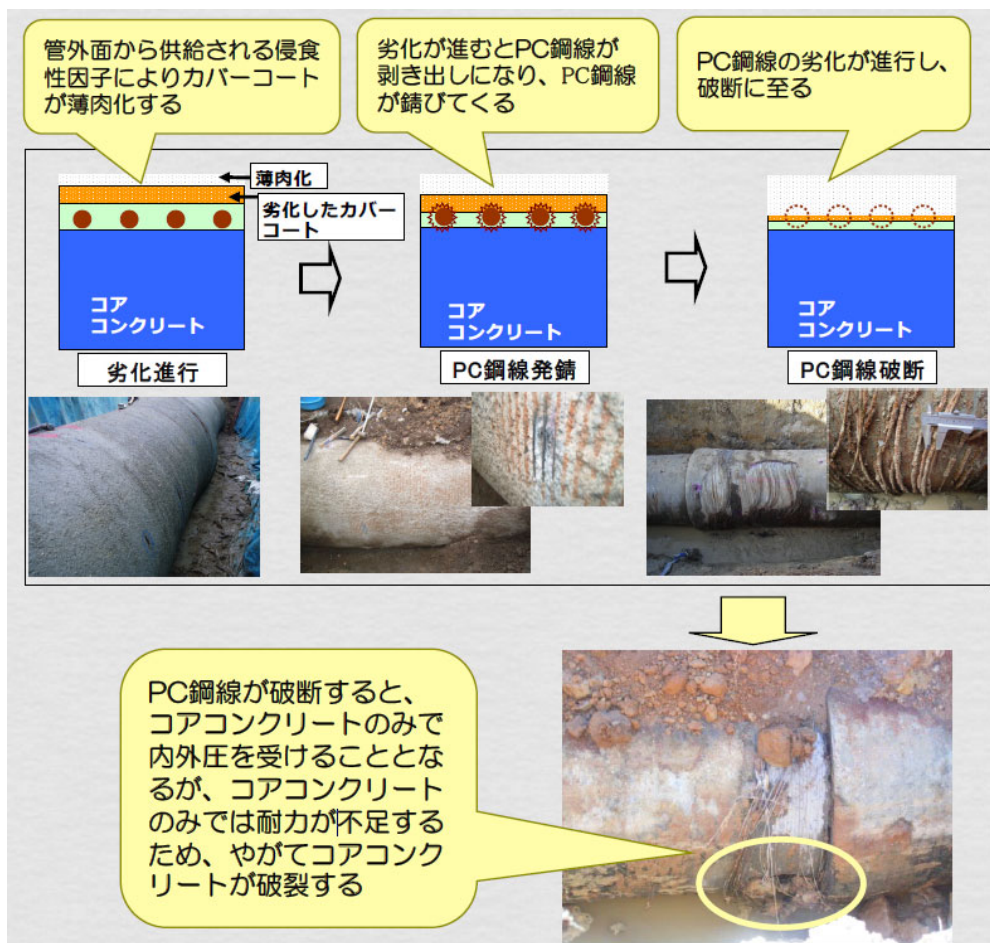
図 14 カバーコート薄肉化による管体損傷
