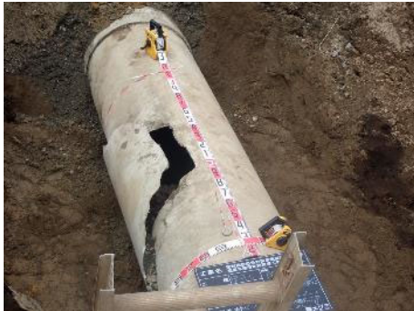
写真 11 管体損傷 (FRPM 管)
