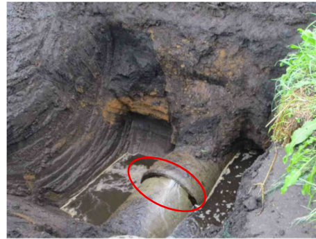
写真 4 継手損傷 (PC 管)
