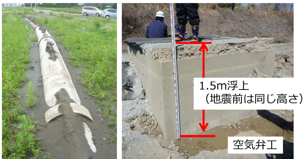
図 44 液状化地盤での被害事例
