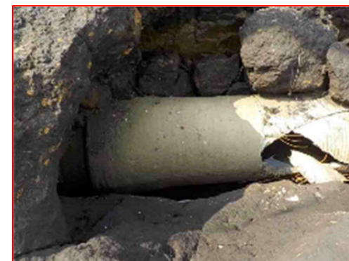
【写真4-1 PC管(PC鋼線の破断による管体破損)】
