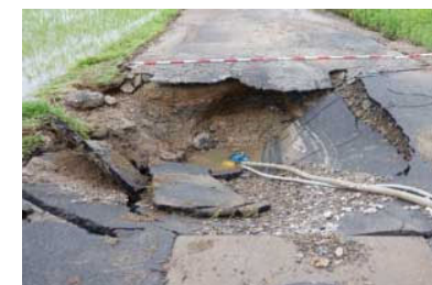
写真2. 事故による道路陥没状況
