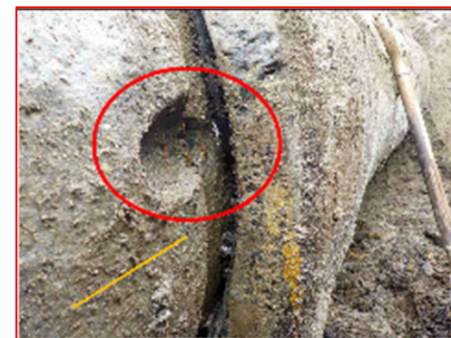
【写真4-2 PC/RC管(継手ゴム劣化・腐食)】
