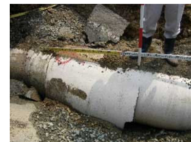
写真1. パイプライン破損状況
