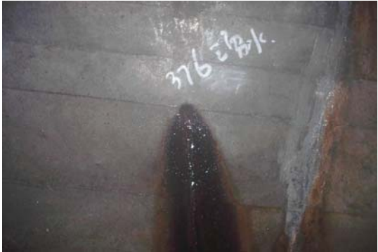
過剰水圧；局所的な劣化部からの噴水
