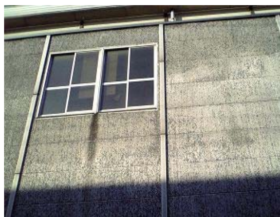
工場に隣接する建築で、煤煙による風化が進んでいる。海岸が近く塩害の影響も見られる。
