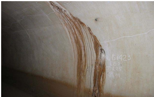
ひび割れ部からの漏水
