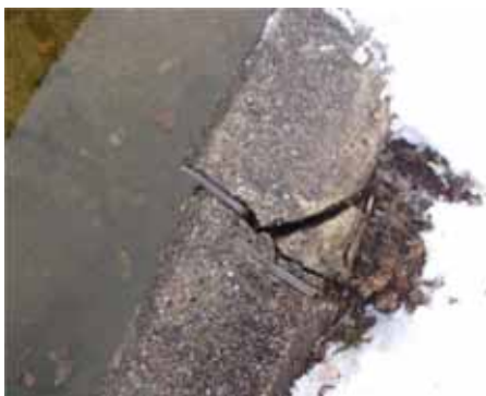
写真-1.2.25 止水板の破断
