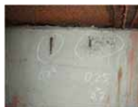
鉄筋の露出 (被り不足)
