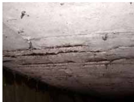
写真-1.2.9 中性化（ボックスカルバート；鉄筋に沿ったひび割れ；塩害も同様の形状を示す）
