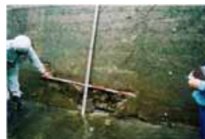
水路側壁の変形・ひび割れ
