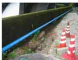
水路側壁周辺の陥没
