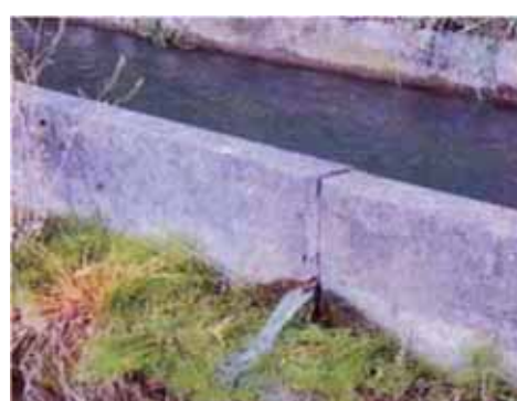
写真-1.2.26 止水板の破断に伴う漏水
