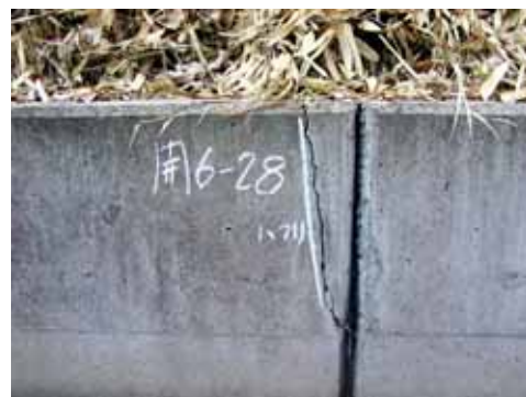
写真-1.2.24 周縁コンクリートの欠損
