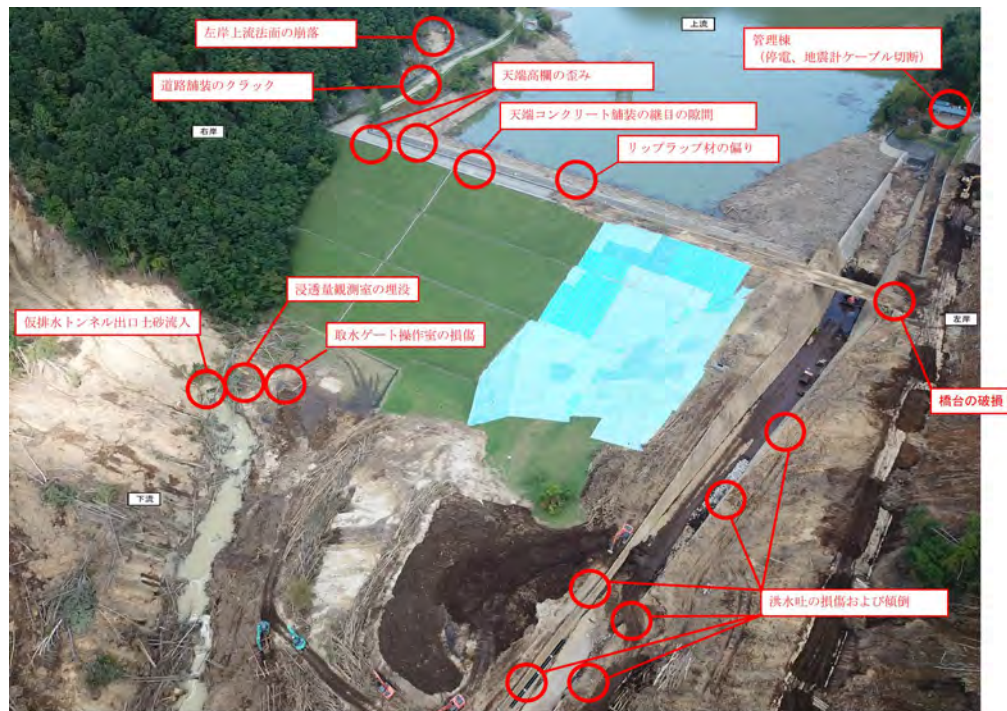
[堤体周辺部の被災状況]
