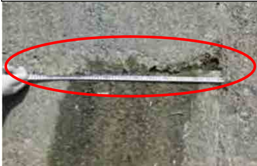
写真23:水路側壁 クラックからの漏水
