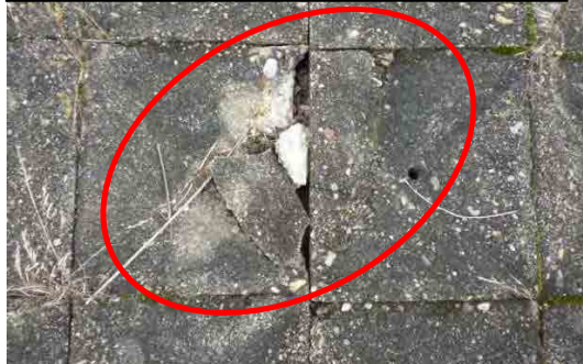
写真18: 上流法面ブロックの損傷
