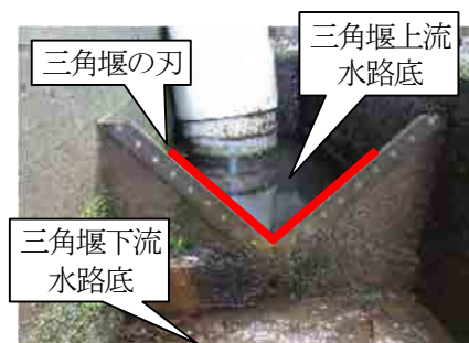
写真12：浸透量観測施設(三角堰)
