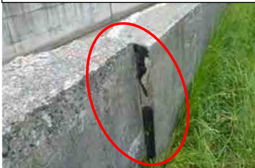
写真25:水路側壁 のたわみ
