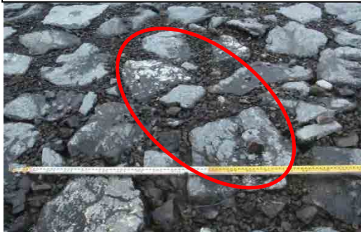
写真17: 上流法面のリップラップ材の細粒化
