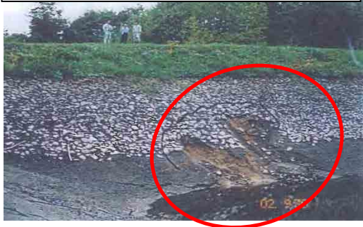
写真15: 堤体上流法面の陥没
