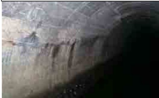
写真32:底樋側壁のひび割れ
