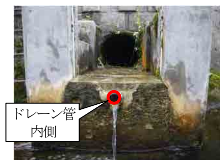
写真13：浸透量観測施設 (ドレーン出口)
