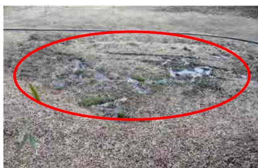
写真21：堤体法尻からの浸み出し
