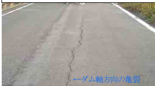
写真8：堤体天端の亀裂
