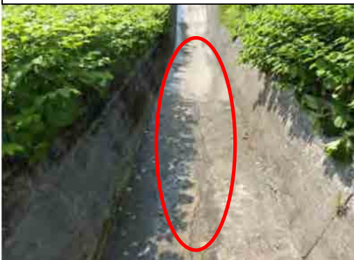
写真27:水路底版の損傷
