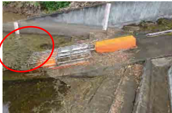
写真36:取水部周辺の土砂やゴミの堆積
