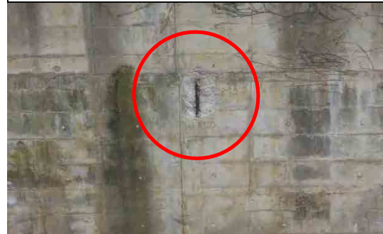
写真24:部材の損傷・鉄筋の露出
