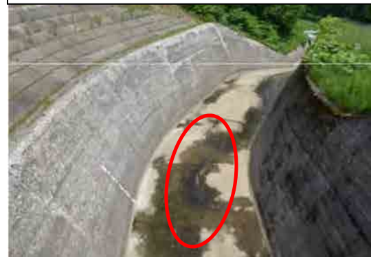
写真28:水路底版のすりへり
