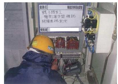
テスターによる電圧測定
