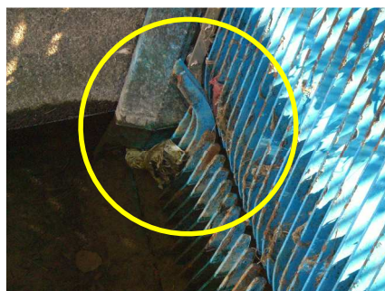
② 水没状態にあるチェンスプロケット、ガイドレールの確認
