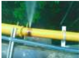
添架管部の漏水
