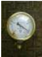
圧力計の故障
