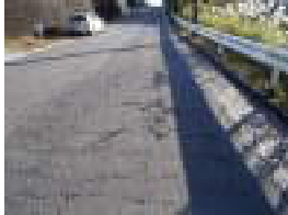
路面のひび割れ・沈下
