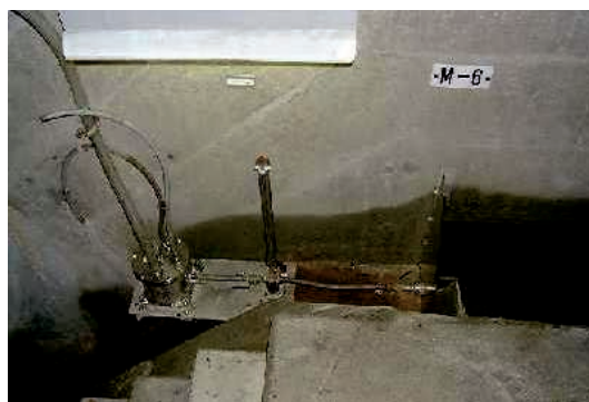
〈三角堰自動計測器〉
