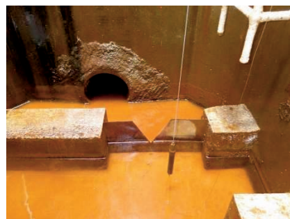
写真例：赤褐色の沈殿物
