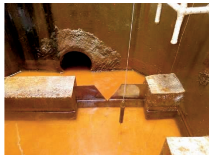
写真例：赤褐色の沈殿物
