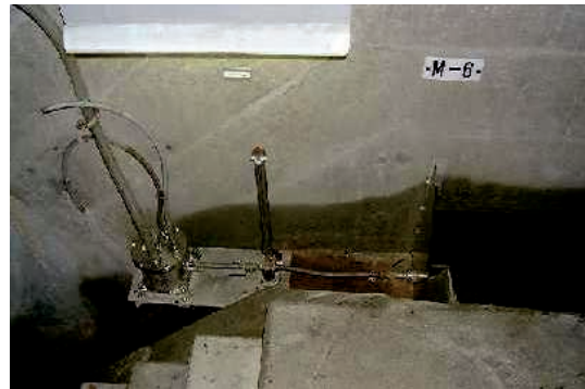
〈三角堰自動計測器〉
