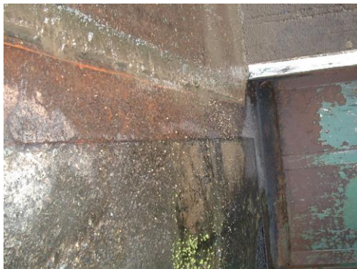
図 2.1.9 シェルゲート内部の腐食
