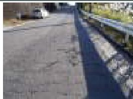
路面のひび割れ・沈下
