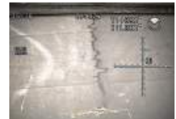
管内クラックの状況
