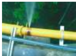
添架管部の漏水
