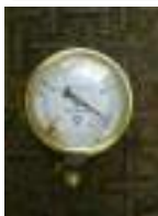
圧力計の故障
