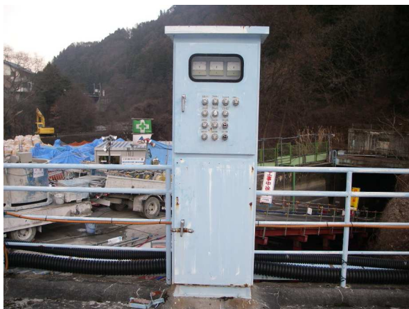
写真-6. 1. 31 機側操作盤の外面劣化の例
