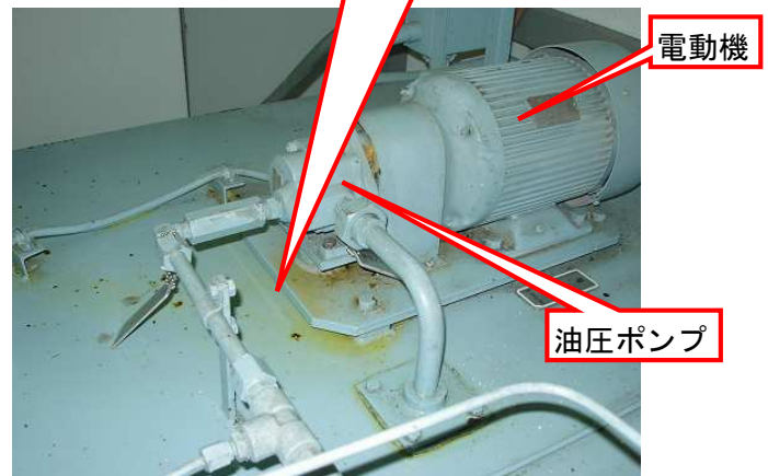
写真-6. 1. 30 油圧ユニットの油漏れの例
