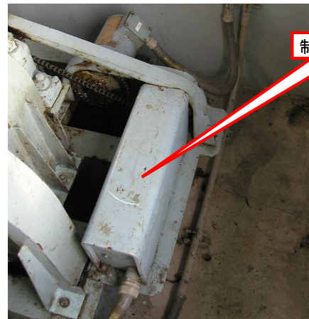
写真-6.1.24 制限開閉器の絶縁不良
