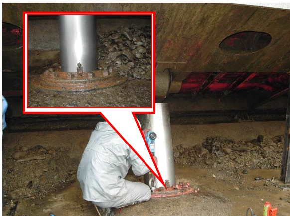
写真-6. 1. 29 油圧シリンダの腐食の例
