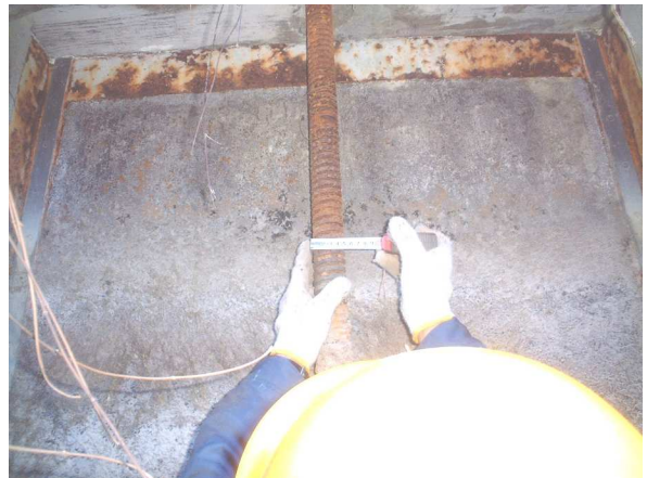
写真-6.1.26 スピンドルの腐食の例
