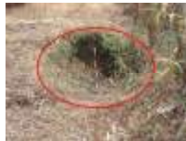
地盤の崩落・陥没
