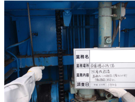
レーキチェーン（除塵機）の動作確認
