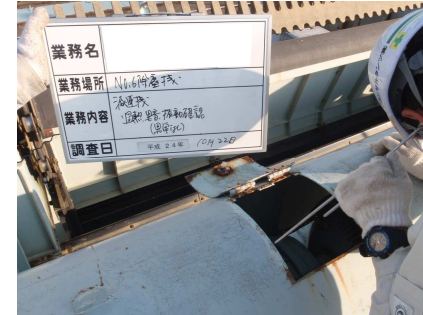
除塵機（減速機）の異常音確認
