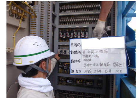
3E リレー（機側操作盤）動作確認
