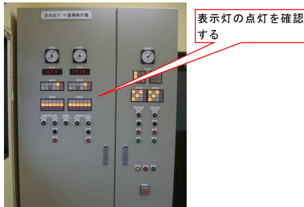
例；機側操作盤の表示確認
