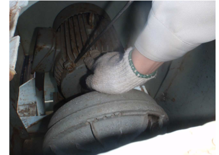
除塵機（電動機）の振動・過熱確認
