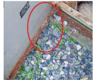
配電盤の下部が腐食し、 隙間からツルが侵入
