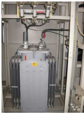
(主変圧器盤内)
