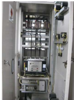
(高圧受電盤内)
