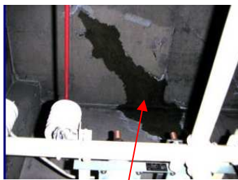
天井から電気室内へ雨漏り
