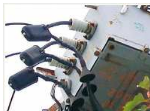
錆の発生（柱上気中開閉器）
