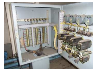
機側操作盤内に塵埃
