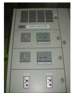
(コントロールセンタ)
