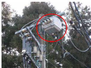
柱上(気中)開閉器
