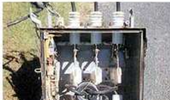
柱上気中開閉器内部に鳥の巣 下の写真は清掃後
