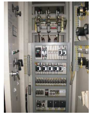
(補機用電動機盤内)
