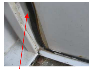
配電盤内のパッキンの剥がれ・劣化
