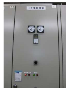
(高圧電動機盤)
