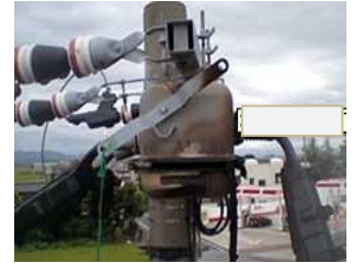
落雷で黒こげになった柱上気中開閉器
