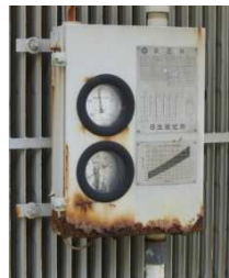
錆の発生（計器盤）
