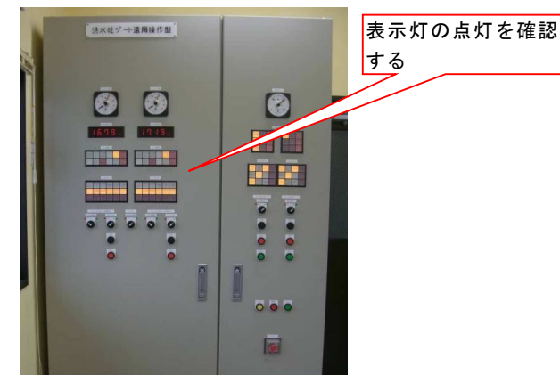
例；機側操作盤の表示確認
