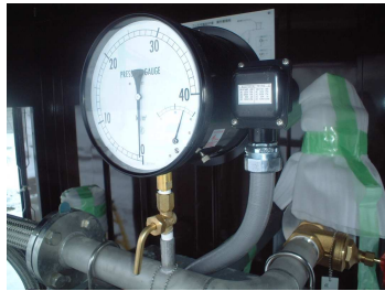
例；内圧検知器の状況
