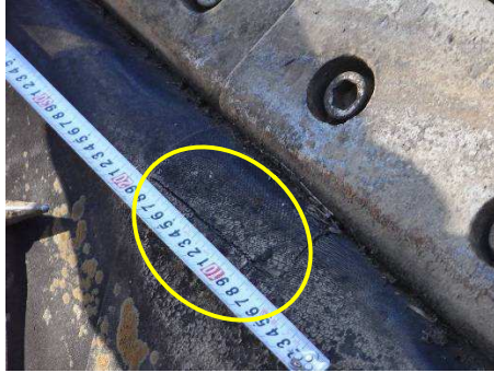
例；袋体に生じた亀裂
