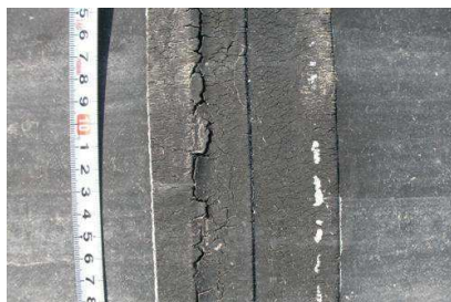
例：継目の変状
