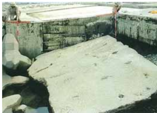
図-4.2.7 底面の空洞化（土砂流出）によるエプロンの陥没
