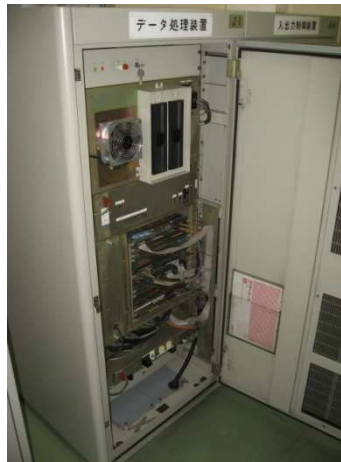
データ処理装置（盤内）
