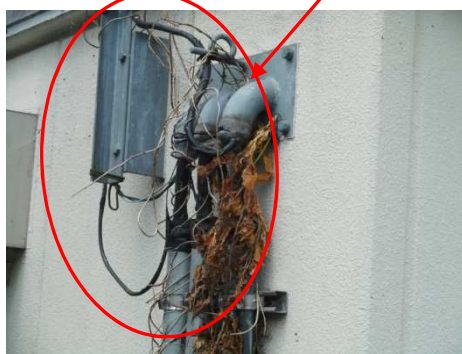
局舎ケーブル引込部状況
