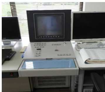
監視操作卓 (入出力中継装置実装)
