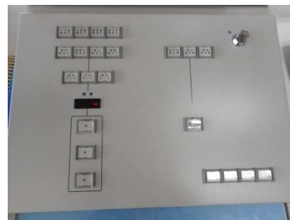
監視操作卓（操作部）
