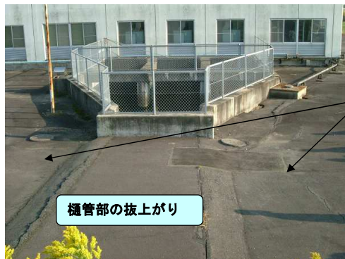
周辺地盤の沈下
