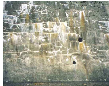
錆汁とゲル（析出物）
