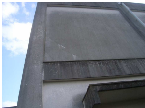
(外壁) ひび割れ 漏水痕跡
