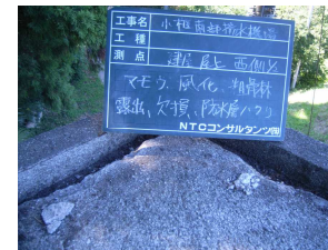
(屋根) 防水層の変状 コンクリート面の欠損
