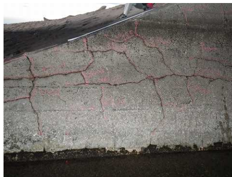
ひび割れのチョーキング例
