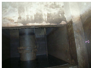
(吸水槽) 摩耗 表面の欠損・剥落
