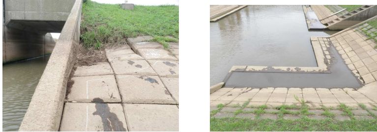
周辺地盤の陥没による護岸ブロックの沈下
