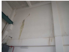
(内壁) 防水層の変状 ひび割れ 漏水痕跡
