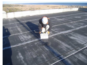
(屋根) 防水層の変状
