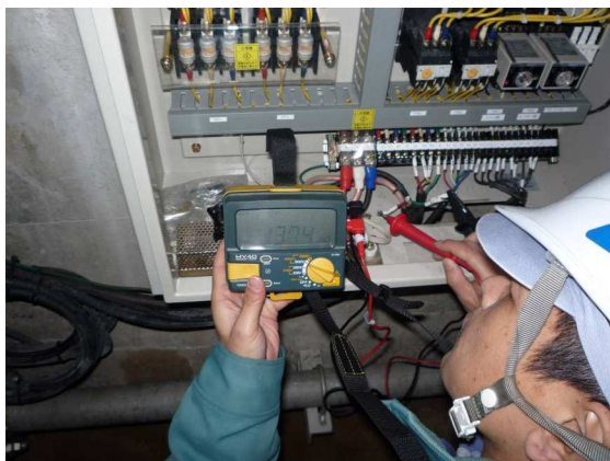
絶縁抵抗測定 NO.1 ポンプ U-E間 137.4MΩ (1000MΩ以上)
