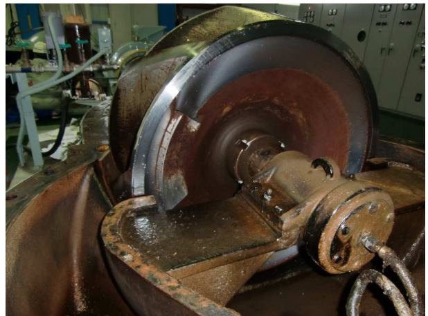
④水中軸受部 (劣化影響度 A)
