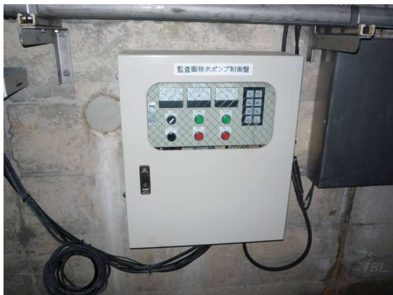
機側制御盤 正面外観
