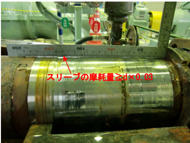
③軸封部・スリーブ (劣化影響度 A)
