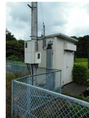
局舎設置環境
