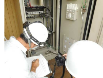
盤内状況確認
