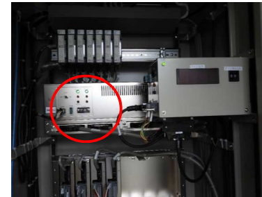
LEDランプ切れの確認
