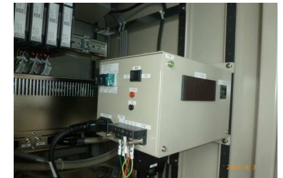
盤内状況（現場計測データ表示装置）
