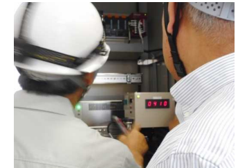
盤内表示装置確認
