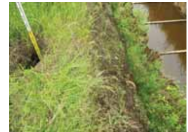
周辺地盤の陥没
