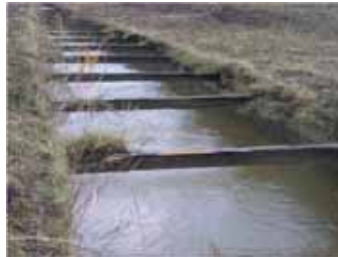
切梁の変状（塗装の劣化）
