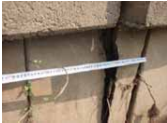
矢板の亀裂・損傷
