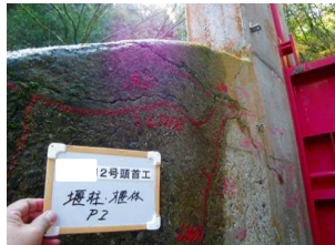
ひび割れ（外力）
