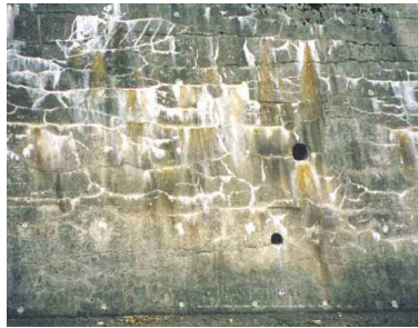
錆汁とゲル（析出物）
