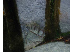
鉄筋露出（摩耗による）
