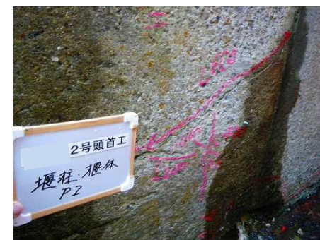
ひび割れのチョーキング例
