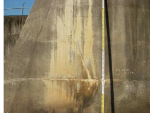
ひび割れ（初期ひび割れ）
