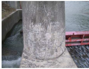
ひび割れ（凍害）
