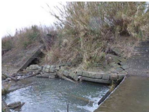
護岸工背面の空洞化 （護岸ブロックの崩落）
