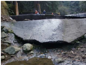
エプロン下の空洞化
