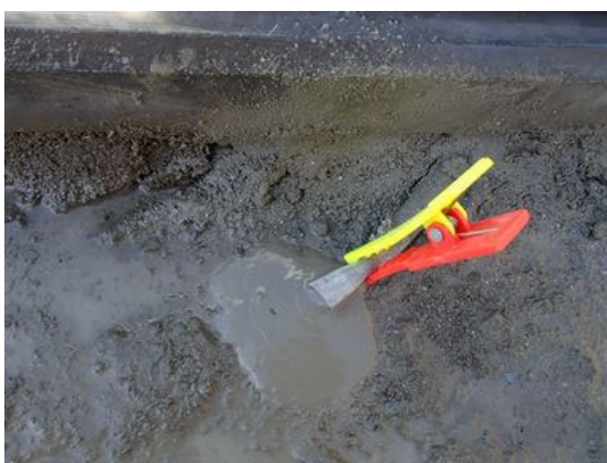
写真 4.2-8 グラウト流出確認状況（エプロン）
