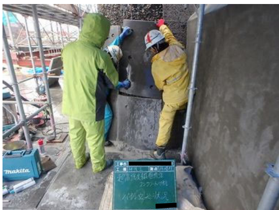
写真 4.2-13 超高強度繊維補強コンクリート パネル設置状況（堰柱下部）
