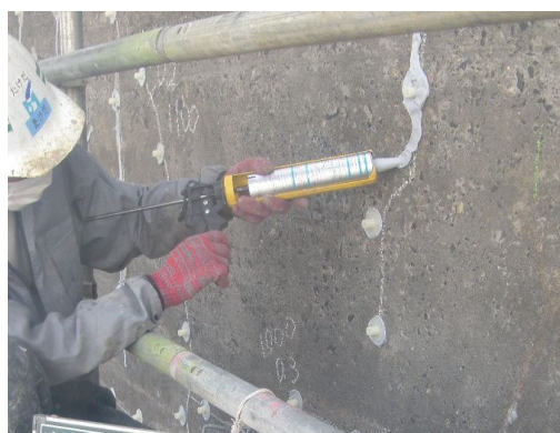
写真 2.3-20 シリンダー工法 魚道のリーク防止シール・注入治具設置状況
