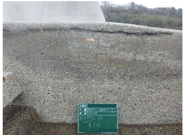
写真1.6-12 魚道(側壁)の摩耗・骨材露出、ひび割れ
