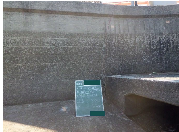
写真1.6-18 沈砂池(側壁)のひび割れ
