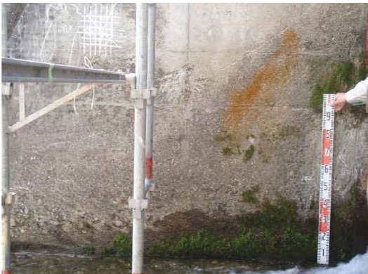
写真1.7-17 ST頭首工 堰柱の土砂吐きゲート直下流の摩耗状況
