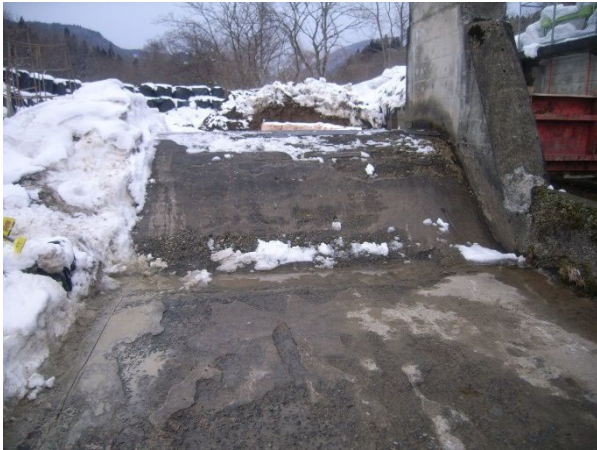
写真1.6-1 固定堰(堰体)・エプロン部の摩耗・骨材露出
