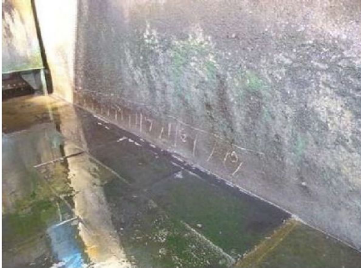
写真1.7-15 N頭首工 堰柱側面下端の摩耗状況
