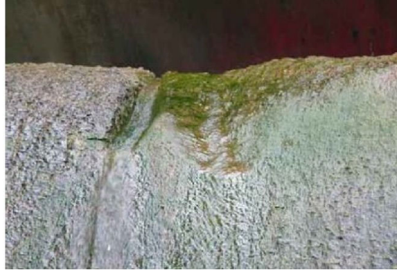
写真1.7-2 F頭首工 溝状の摩耗の拡大写真
