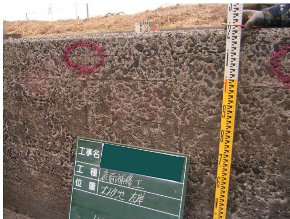
写真1.6-17 沈砂池の摩耗・骨材露出
