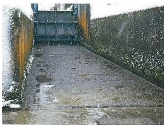
写真1.7-4 M Y頭首工 土砂吐き下流エプロンの導流壁側の摩耗
