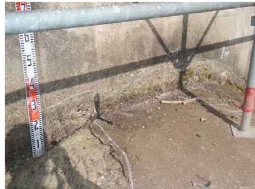
写真1.7-18 ST頭首工 堰柱固定堰側の摩耗状況
