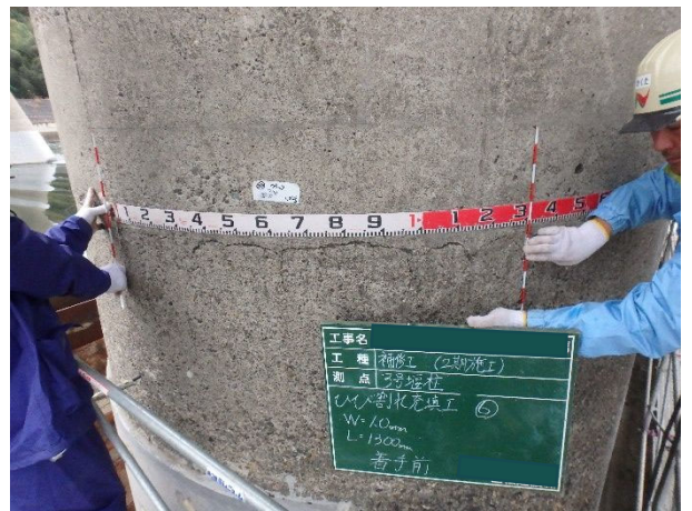
写真1.6-8 堰柱のひび割れ
