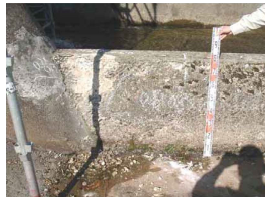
写真1.7-20 ST頭首工 導流壁 固定堰側の摩耗状況
