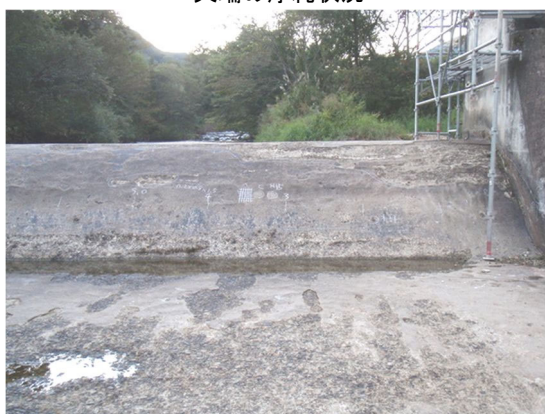
写真1.7-8 ST頭首工 固定堰とエプロンの摩耗状況
