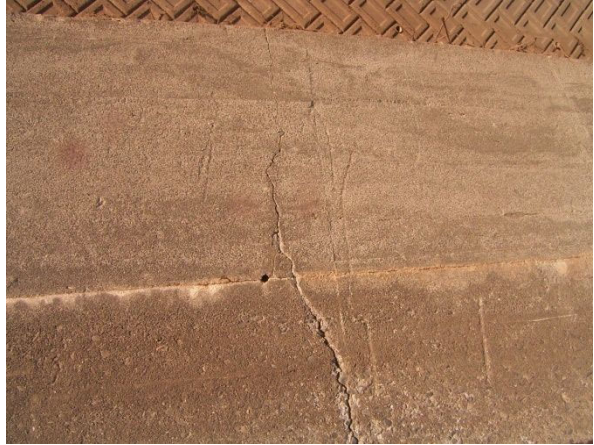
写真1.6-20 護岸工のひび割れ
