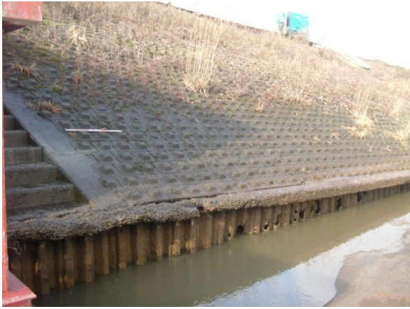
写真1.6-19 護岸工(笠コン)の摩耗・骨材露出
