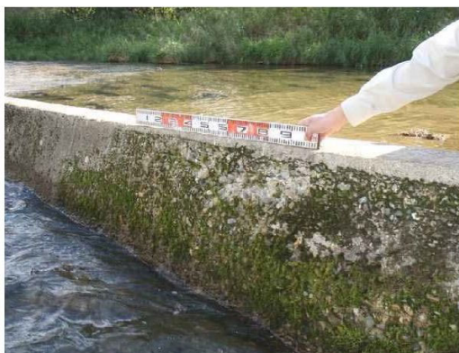
写真1.7-19 ST頭首工 導流壁 土砂吐き側の摩耗状況
