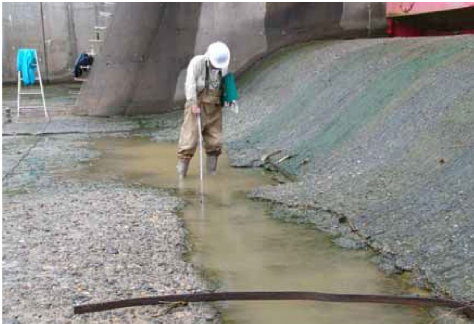
写真1.7-5 Z頭首工 可動堰下流スロープ端部の摩耗状況
