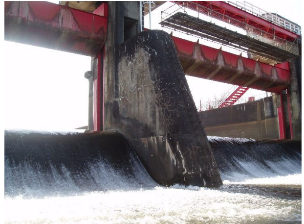
写真1.6-6 堰柱のひび割れ、遊離石灰
