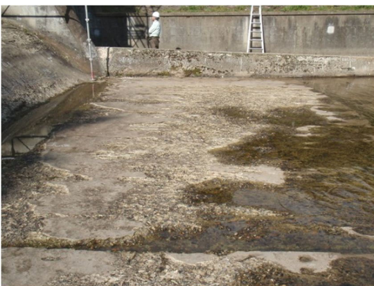
写真1.7-11 ST頭首工 エプロンの摩耗状況
