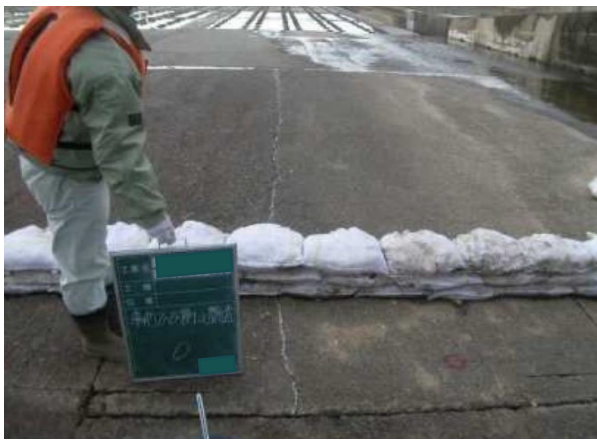
写真1.6-3 エプロン部のひび割れ
