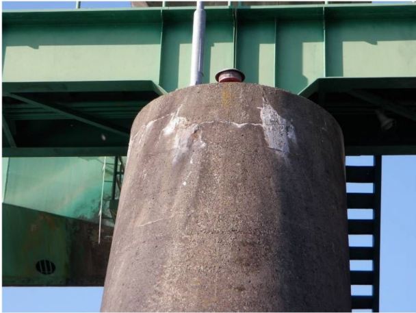
写真1.6-5 堰柱のひび割れ、遊離石灰
