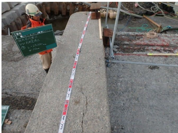
写真1.6-13 魚道(側壁天端)のひび割れ
