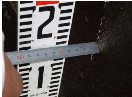
写真1.7-16 N頭首工 堰柱最大摩耗深さ40mm
