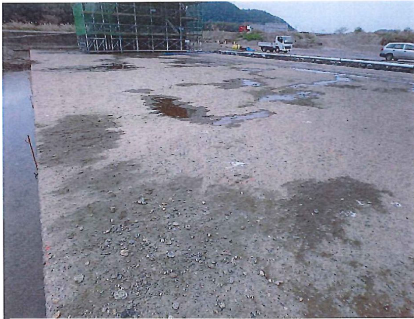
写真1.7-14 ○B頭首工 洪水吐き下流エプロンの摩耗状況
