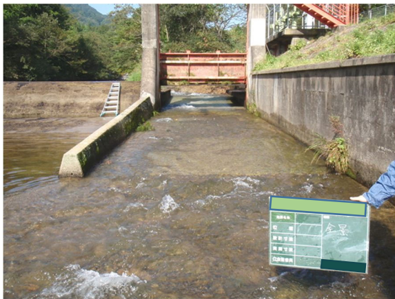
写真1.7-3 S T頭首工 土砂吐き下流エプロンの導流壁側の摩耗
