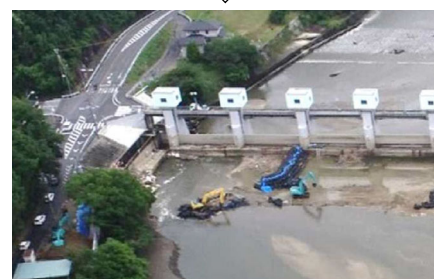
写真 6.1-4 漏水事故による水位低下
