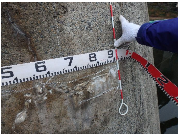
写真1.6-7 堰柱のひび割れ、遊離石灰
