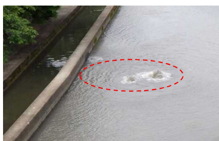
写真 6.1-1 堰下流側（変状初期）
