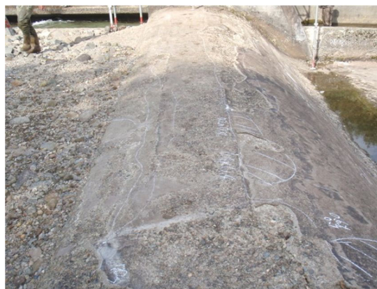
写真1.7-7 ST頭首工 左岸側天端の摩耗状況
