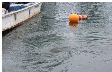
写真 6.1-3 堰上流側（変状拡大時）
