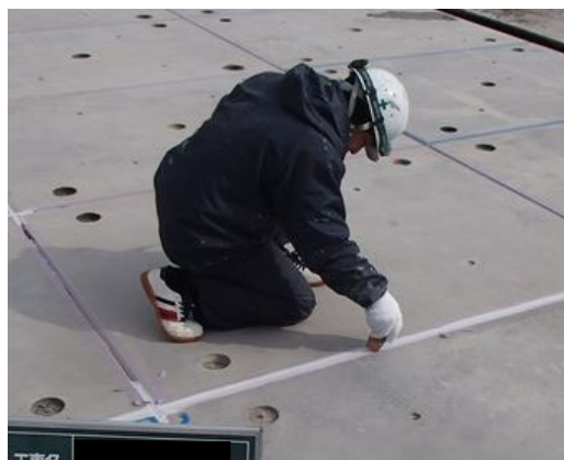
写真 4.2-6 超高強度繊維補強コンクリートパネル 目地材ヘラ仕上げ状況（エプロン）
