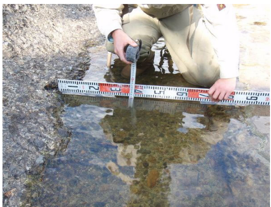
写真1.7-10 ST頭首工 固定堰下流端部の段差100mm
