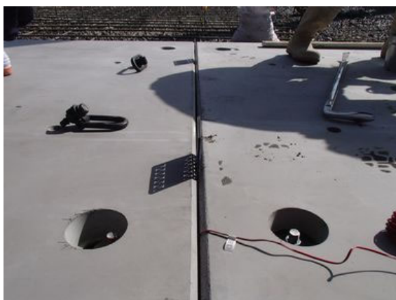
写真 4.2-3 超高強度繊維補強コンクリートパネル ボルト取付状況 (エプロン)
