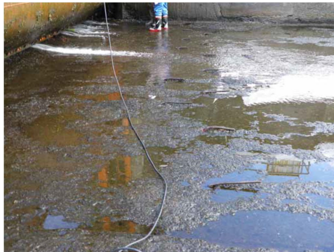
写真1.7-12 K頭首工 土砂吐き下流エプロンの摩耗及び鉄筋露出状況
