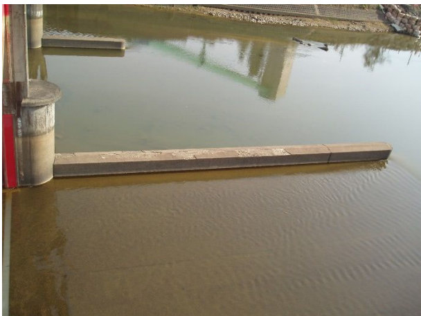
写真1.6-9 導流壁の摩耗・骨材露出
