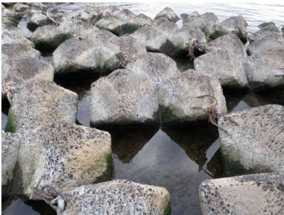
写真1.6-21 護床工(六脚ブロック)の摩耗・骨材露出
