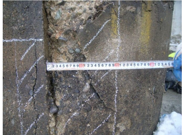
写真1.6-16 取水工(翼壁)の剥離、ひび割れ
