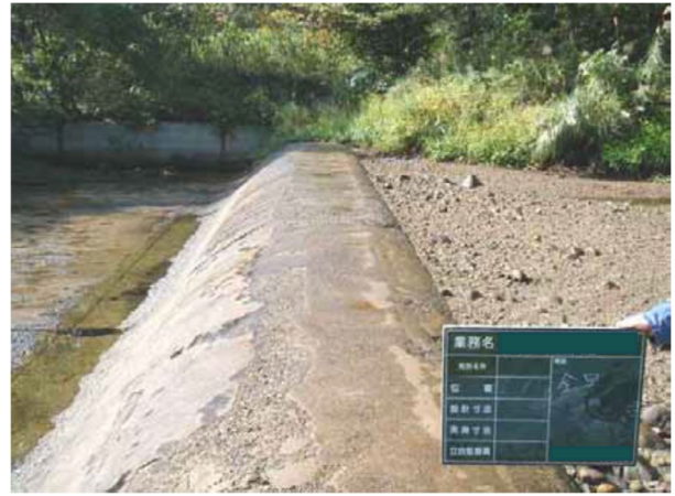
写真1.6-2 固定堰(堰体)の摩耗・骨材露出
