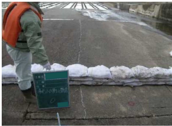
写真1.6-3 エプロン部のひび割れ
