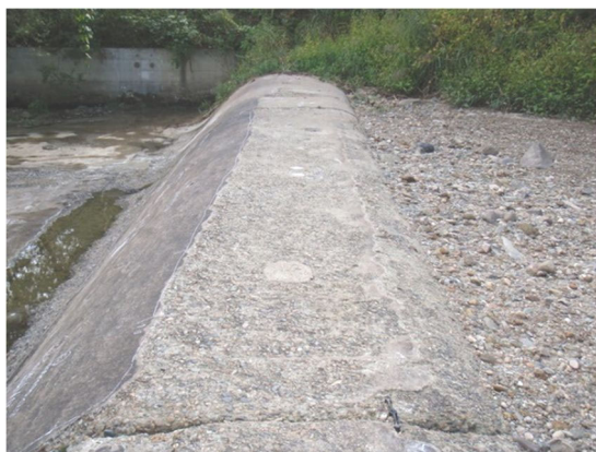
写真1.7-6 ST頭首工 右岸端部以外の天端の摩耗状況
