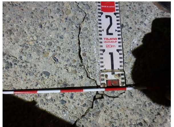
写真1.6-14 魚道(側壁天端)のひび割れ
