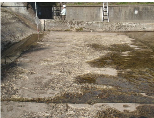
写真1.7-11 ST頭首工 エプロンの摩耗状況
