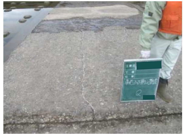
写真1.6-4 エプロン部のひび割れ
