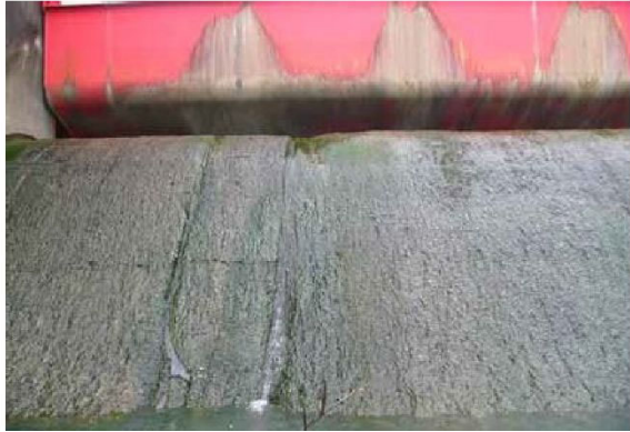
写真1.7-1 F頭首工 可動堰下流スロープの全面摩耗と溝状の摩耗
