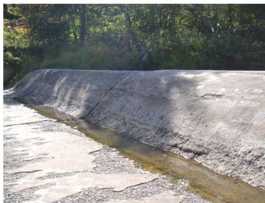
写真1.7-9 ST頭首工 固定堰とエプロンの摩耗状況
