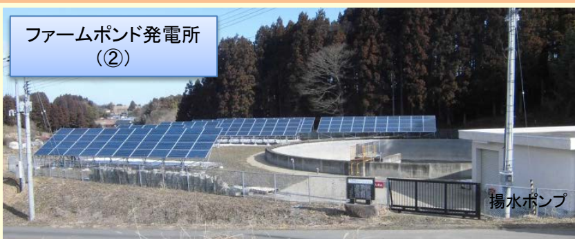
ファームポンド発電所 (④)
