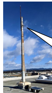
LPWA 基地局 (袋井市役所屋上)
